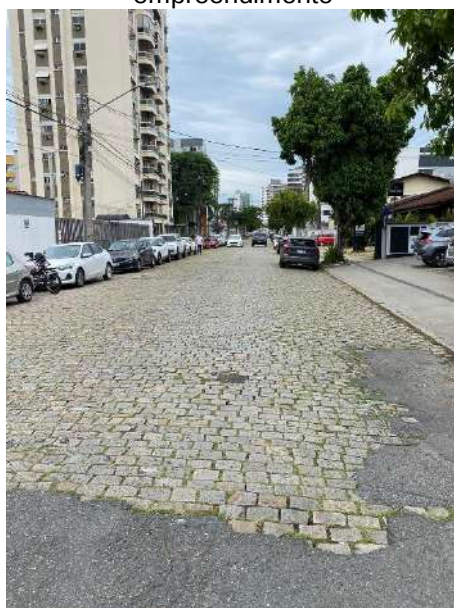
Pavimento na Rua Dr Plácido Gomes sem pintura
