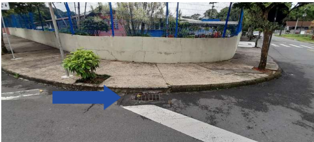
Imagem 13 - Área de captação de água pluvial Esquina das Rua das Cabeladeiras e Rua Willy Affonso Jacob
