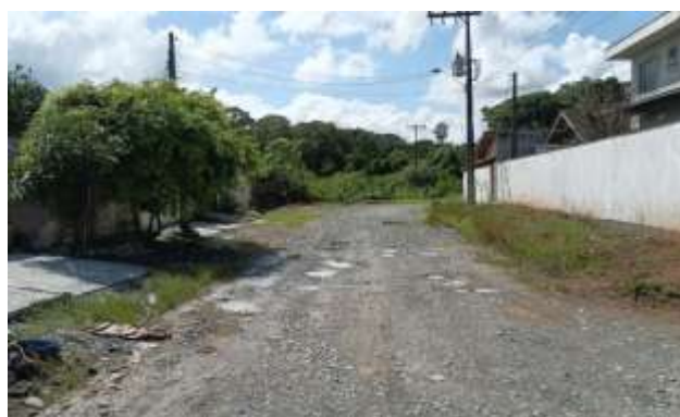
Figura 135 – Rua Cidade de Guarulhos – ETE a Frente (Ponto 5A)
