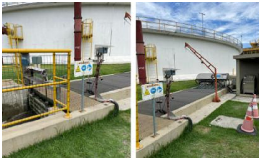
Figura 20 – Canal de desinfecção UV.
