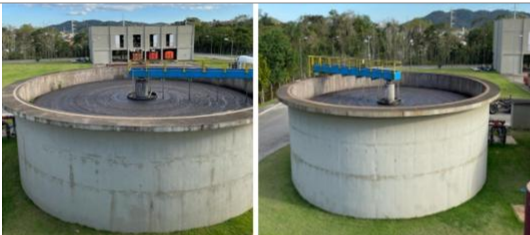
Figura 26 – Adensadores por gravidade da ETE Jarivatuba.
