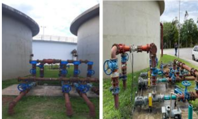
Figura 29 - Elevatória de Deságue de Lodo.
