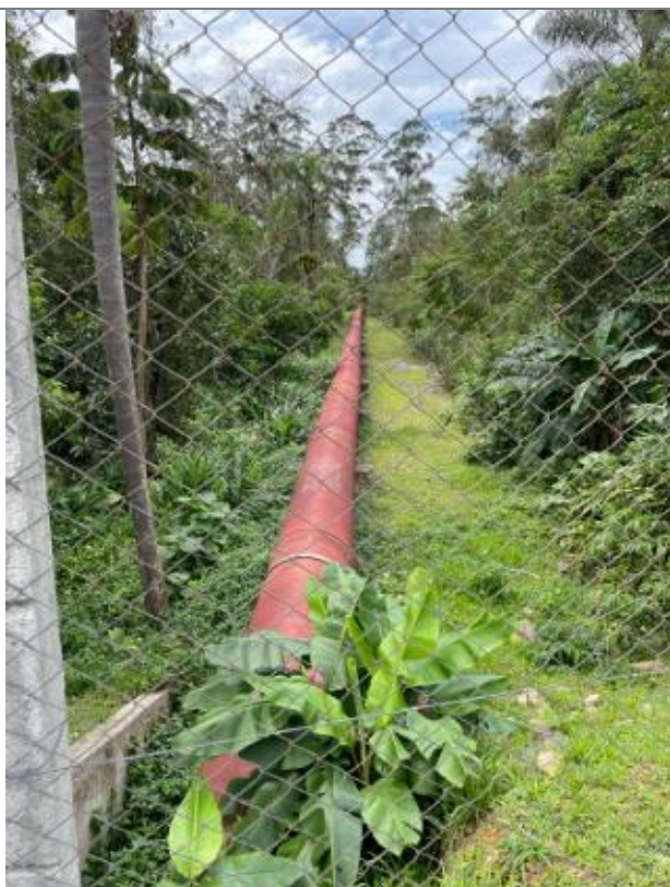
Figura 22 – Emissário final da ETE Jarivatuba
