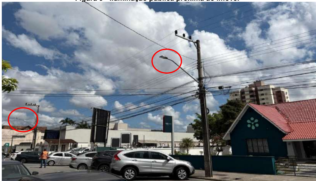
Figura 9 - Iluminação pública próxima ao imóvel
