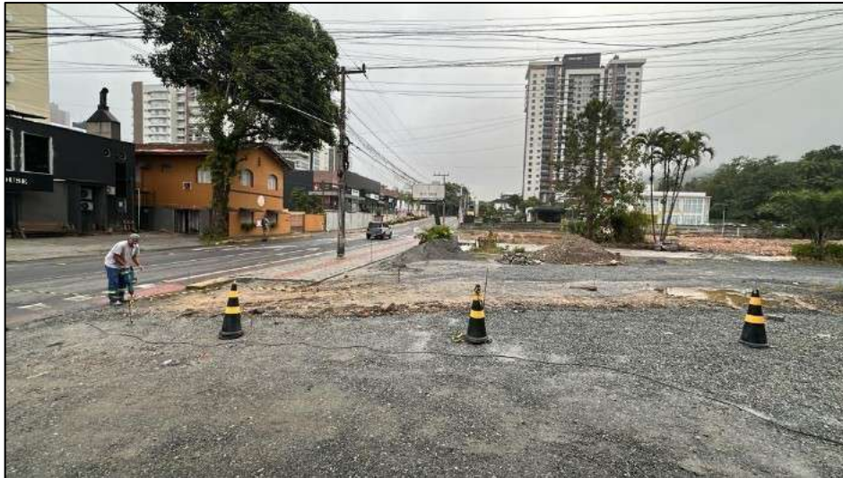
Figura 56 - Condição do passeio e da via em frente ao empreendimento. Fonte: proprietário, julho/2026.
