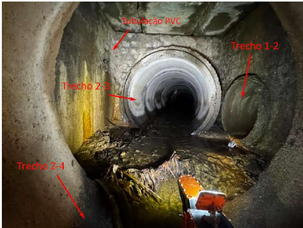
Figura 10 - Tubulações dentro da caixa.
