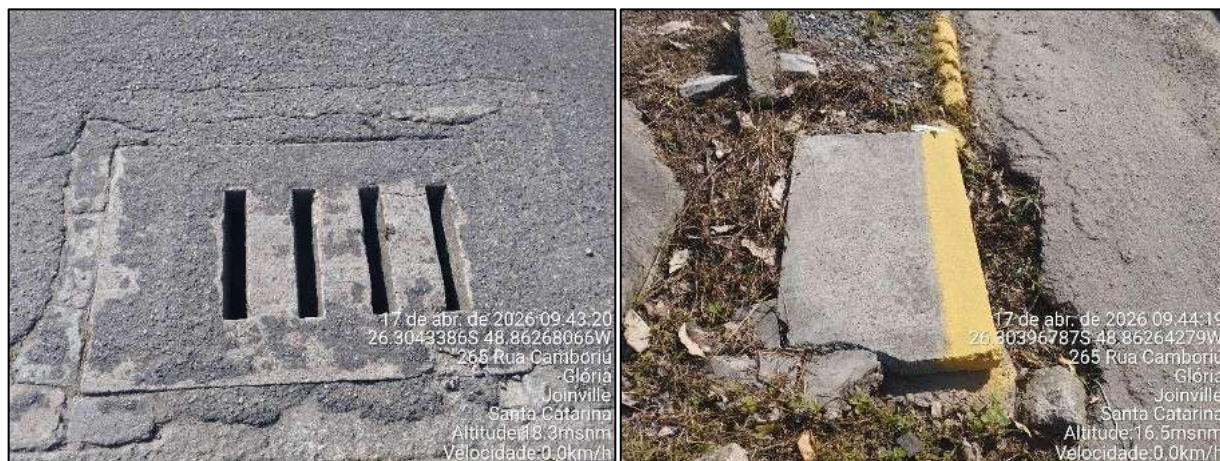
Figura 33 - Coleta de drenagem pluvial em frente ao empreendimento. Fonte: Bioeco, 2026.
