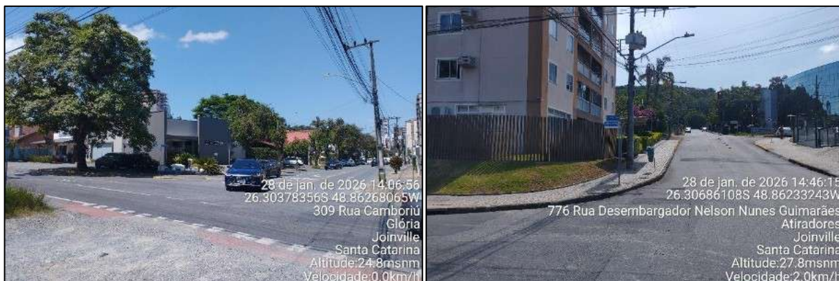
Figura 38 - Iluminação pública na Rua Camboriú e na Rua Des. Nelson Nunes Guimarães. Fonte: Bioeco, 2026.
