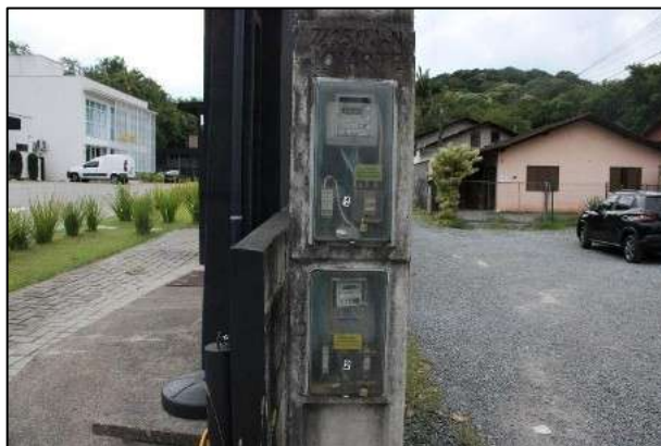
Figura 40 - Distribuição de energia elétrica no empreendimento. Fonte: Bioeco, 2026.
