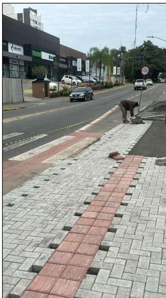
Figura 55 - Condição do passeio e da via em frente ao empreendimento. Fonte: proprietário, julho/2026.
