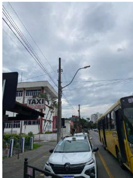
Postes de iluminação pública da AIE
