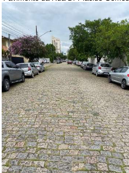
Pavimento da Rua Dr Plácido Gomes sem pintura
