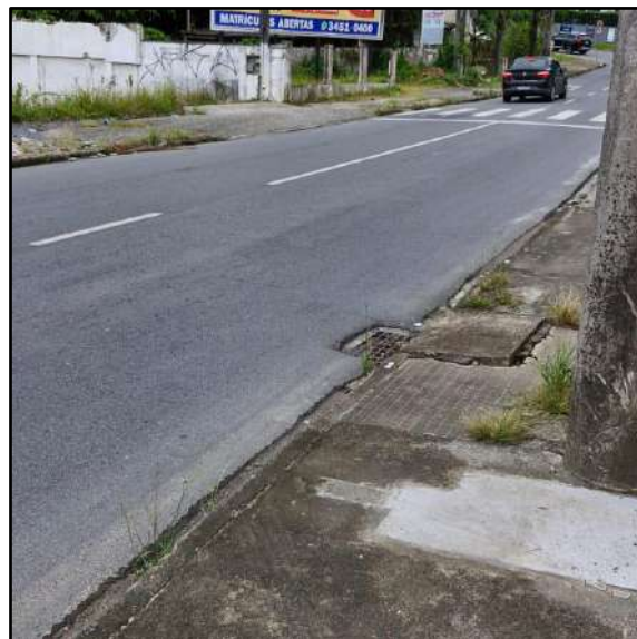
Figura 18: Boca de lobo na Rua Marajó. Fonte: Arquivo pessoal, 2025.
