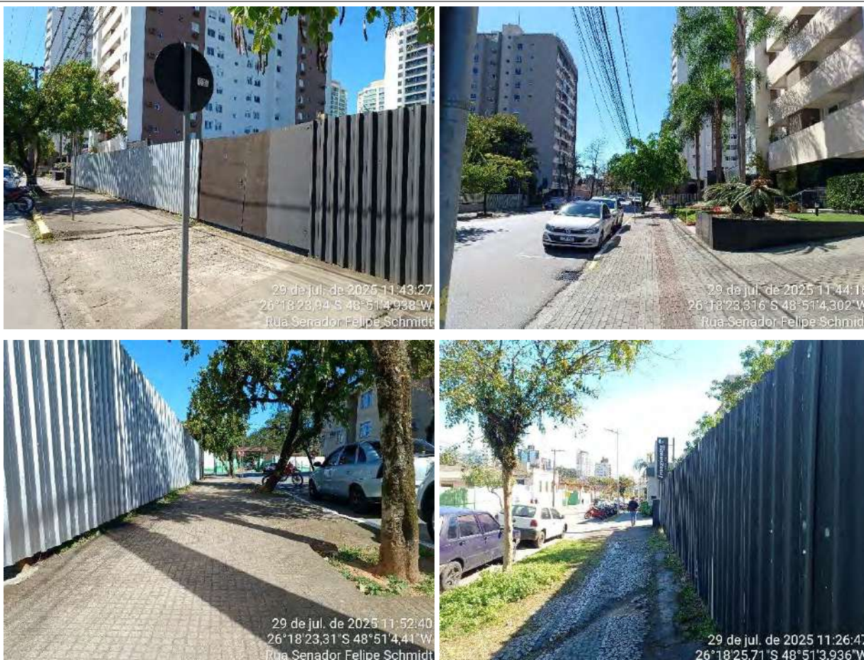
Figuras 28, 29, 30 e 31: Condições dos passeios na ADA do empreendimento.
