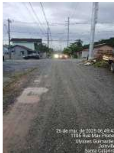
Figura 58 – Rua Eurídes Francisco Tomasoni (Sentido AB), sem sinalização e pavimento em terra.
