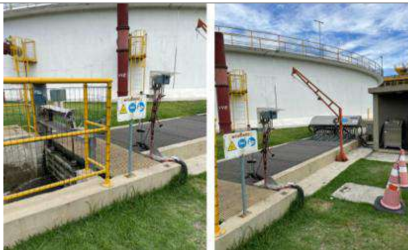
Figura 20 – Canal de desinfecção UV.
