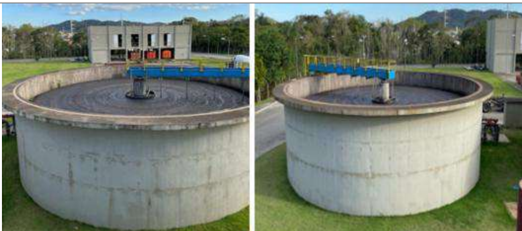
Figura 26 – Adensadores por gravidade da ETE Jarivatuba.
