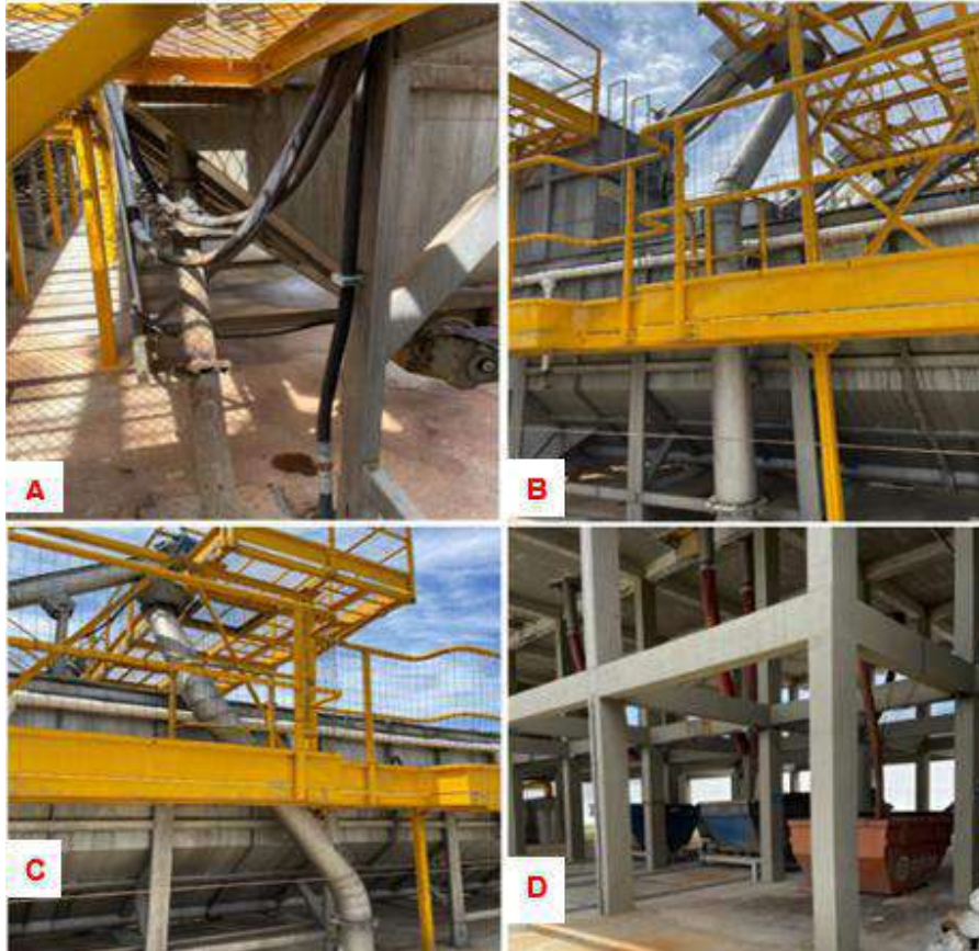
Figura 7 – Tratamento preliminar. Detalhes das tubulações de saída de resíduos dos equipamentos. A – Sólidos retidos nas peneiras; B - Gordura (óleos e graxas) e C - areia e silte. D – Detalhe do caminhamento das tubulações até as caçambas.
