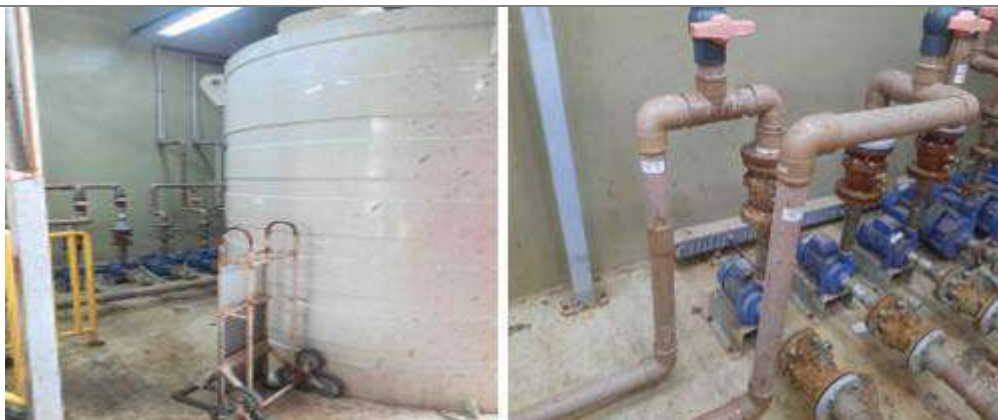
Figura 33 – ETL, piso inferior. À esquerda, reservatório de água. À direita, bombas para lavagem das prensas
