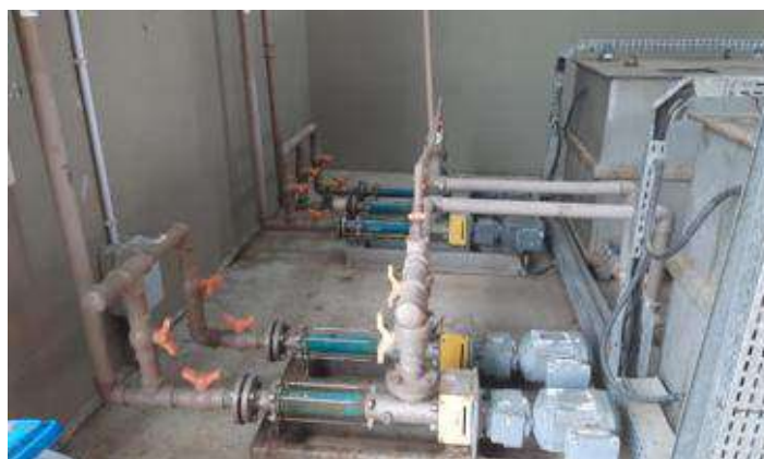
Figura 34 – Bombas de recalque de polímero preparado para o tanque de mistura de lodo.
