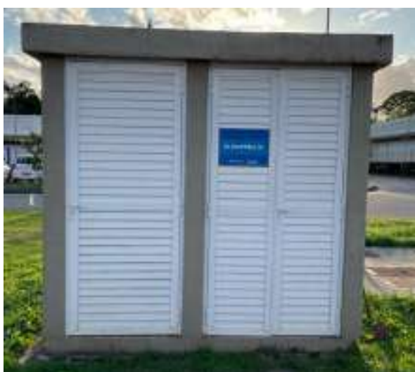
Figura 28 – Elevatória de Retorno de Água dos Adensadores - EE-01.
