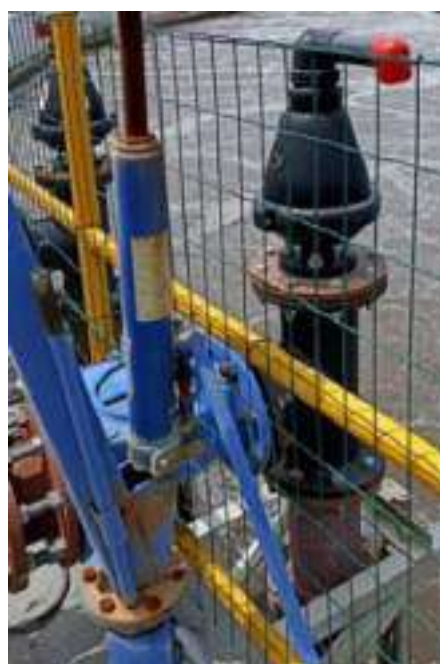
Figura 23 – Tubulação de descarte de excesso de lodo ativado dos reatores.
