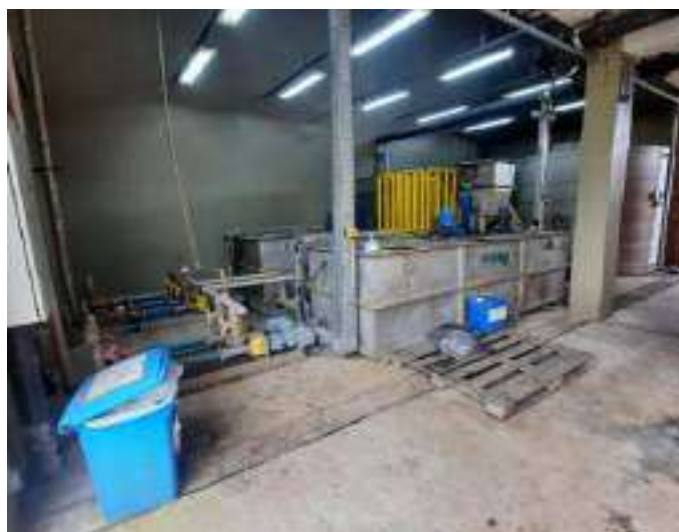
Figura 35 – Vista geral da ETL, piso inferior. Ao centro, as 02 unidades de preparo e dosagem de polímero (UAPs). Detalhe das bombas de recalque de polímero preparado e da tubulação de recalque tanque de mistura, no piso superior.
