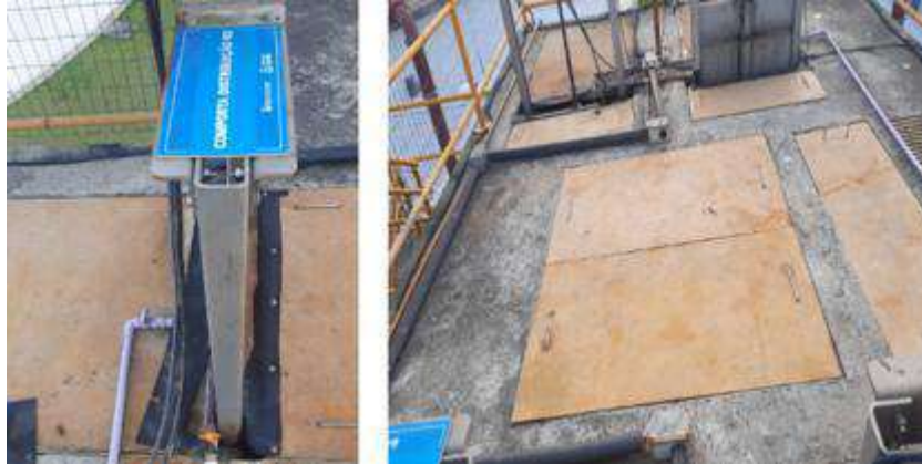
Figura 10 – Comportas da Torre de Distribuição. Detalhes da comporta motorizada e das tubulações rosa (NaOH) e laranja (FeCl3) chegando
