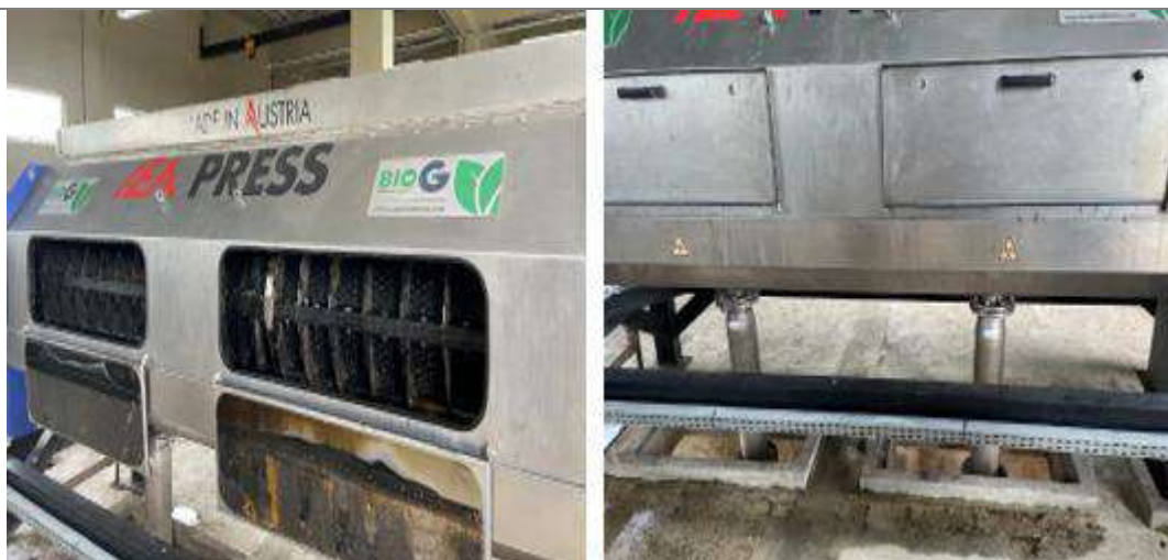
Figura 38 – Prensa parafuso em operação. À esquerda, detalhe de uma prensa parafuso com as tampas abertas para inspeção. À direita, detalhe da tubulação de descarte da torta de lodo para as caçambas no piso inferior.
