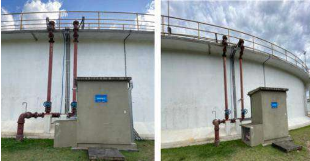
Figura 24 – Tubulação de recalque lodo de descarte projetando-se para fora dos reatores
