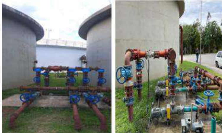
Figura 29 - Elevatória de Deságue de Lodo.
