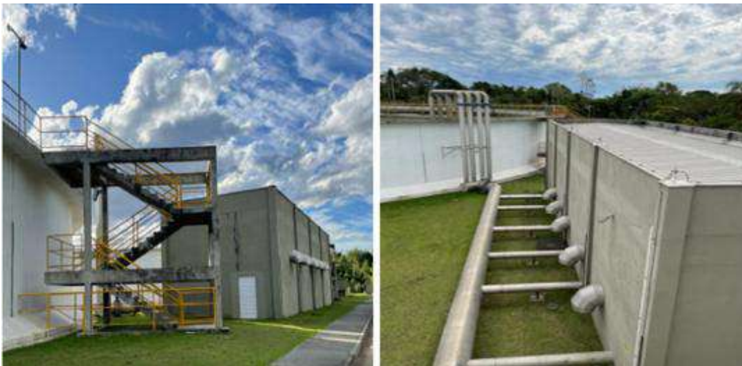
Figura 15 – À esquerda, vista externa da edificação de Sopradores dos reatores B e D. À direita, tubulação de inox que encaminha o ar para o reator D.
