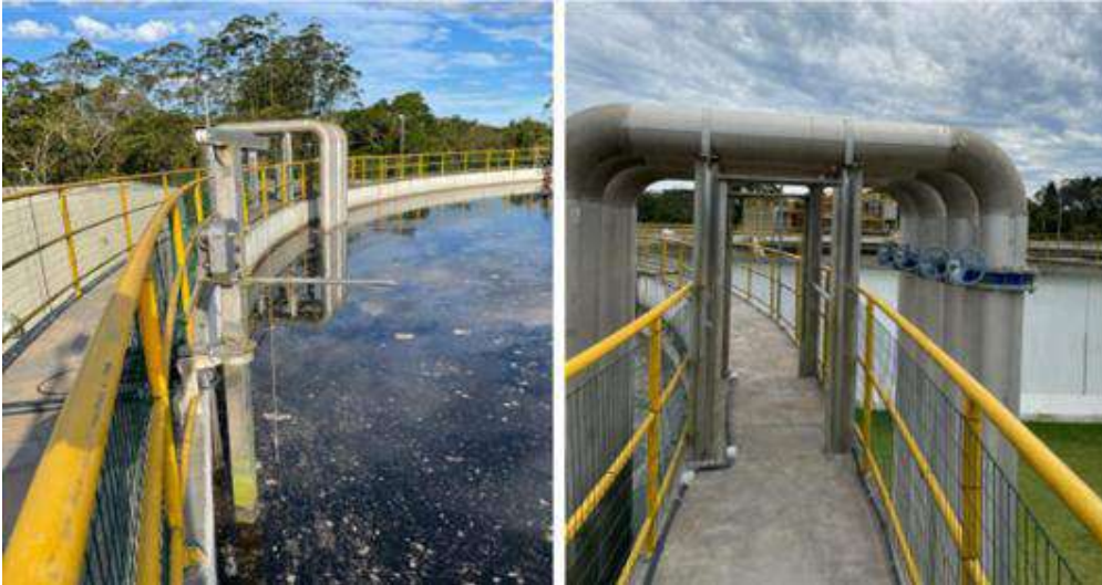
Figura 16 – Chegada da tubulação de inox aos reatores aeróbios. Detalhe das curvas e válvulas de controle na tubulação. Detalhe da tubulação de ar projetando-se para dentro do reator C.
