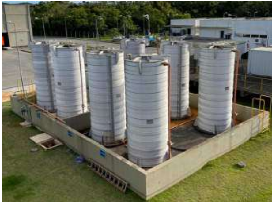
Figura 30 – Tanques de armazenamento de produtos químicos em estrutura de contenção ao lado dos adensadores.
