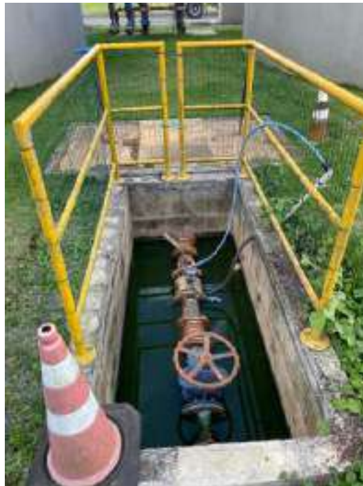
Figura 25 – Caixa de válvula para divisão e alimentação dos adensadores por gravidade, na parte superior, e caixa de medição de vazão de lodo descartado dos reatores, na parte inferior.
