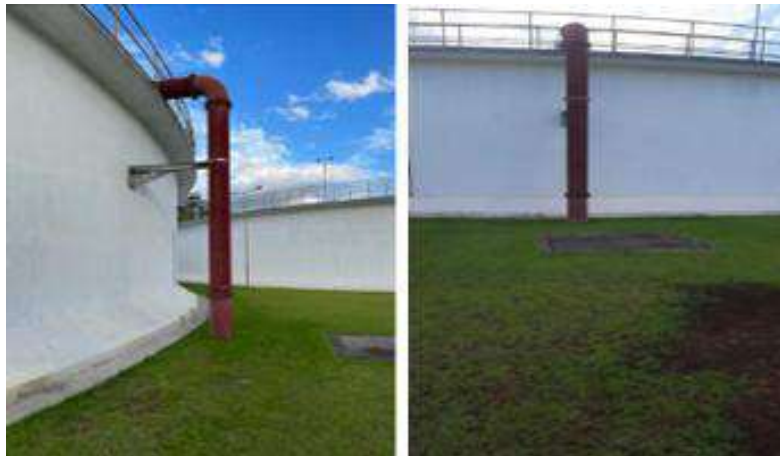
Figura 12 – Entradas independentes de efluente nos reatores aeróbios. Cada reator possui uma tubulação de alimentação.
