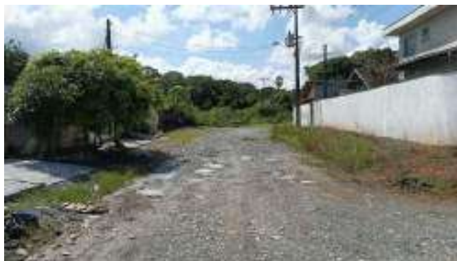
Figura 20 – Rua Cidade de Guarulhos – ETE a Frente (Ponto 5A)
