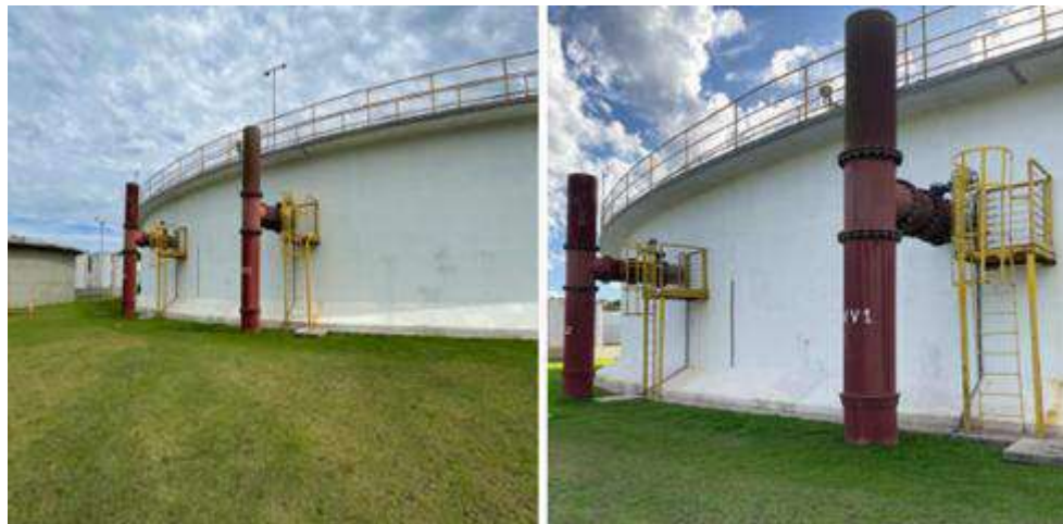
Figura 19 – Tubulações de saída do efluente clarificado dos reatores.
