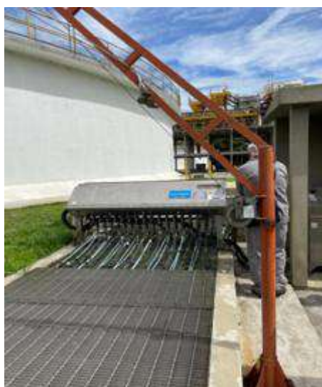
Figura 21 – Canal de desinfecção por UV, com detalhe da disposição da estrutura de suporte das lâmpadas.
