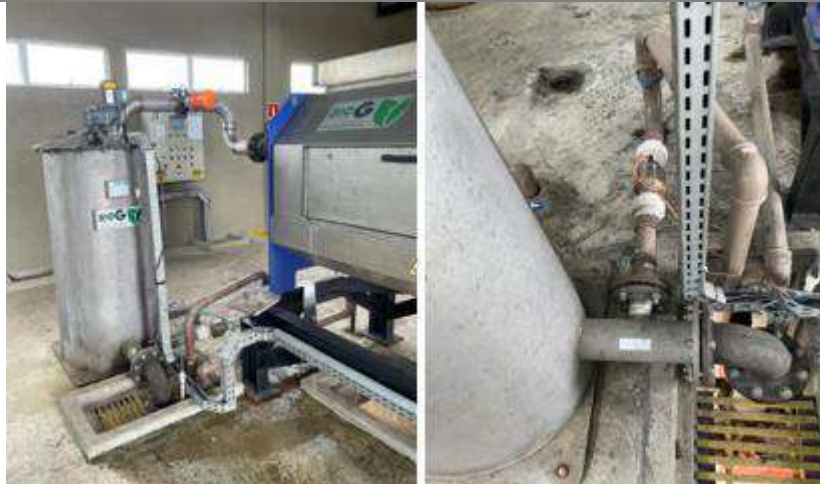
Figura 36 – Tanque de mistura de lodo e polímero preparado no piso superior da ETL, ao lado das Prensas Parafuso. Detalhe das tubulações de lodo e de polímero (PVC) que alimentam o tanque de mistura, e da tubulação de saída do tanque, para alimentação das prensas.
