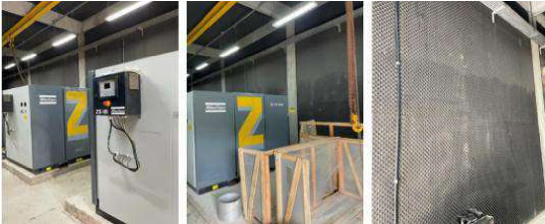
Figura 14 – Vista interna da Casa de Sopradores B e D. Cabine dos sopradores e isolamento acústico.
