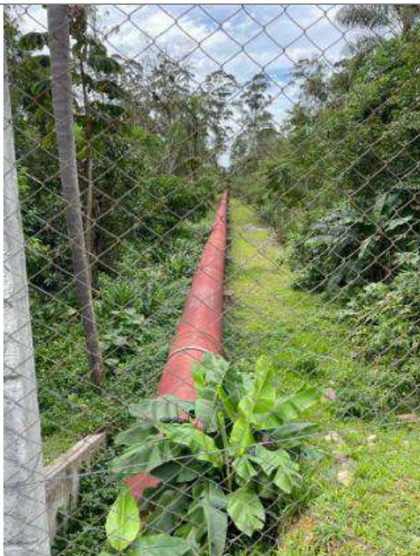
Figura 22 – Emissário final da ETE Jarivatuba
