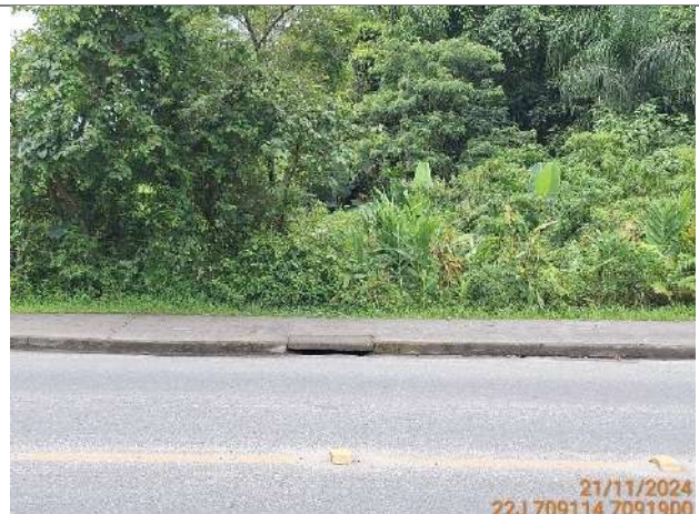
Figura 3.19: Drenagem na Rua Rolando Gurske.
