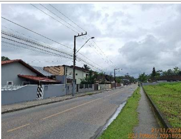
Figura 7: Vista da Rua dos Suíços, pavimento apresenta boas condições, porém com acúmulo de água.
