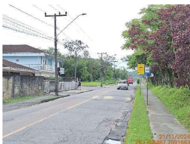
Figura 3.14: Vista da lateral da Rua dos Suíços, pavimento apresenta buracos.
