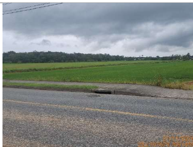
Figura 3.23: Drenagem na Rua dos Suíços.
