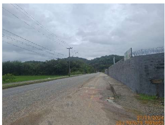
Figura 4.20: Início da via compartilhada, com ponto com necessidade de manutenção, na Rua dos Suíços.
