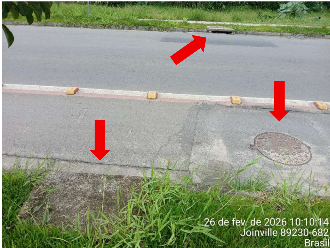
Figura 34: Bocas de lobo e poço de visita, em frente ao local de estudo.
