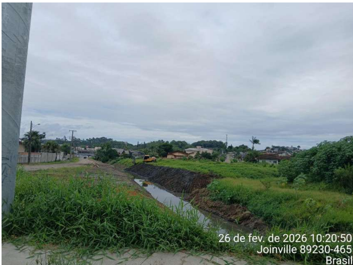
Figura 37: Vala de drenagem, Rua Eurides Francisco Tomasoni com a Rua Renato Caetano da Silva Filho.
