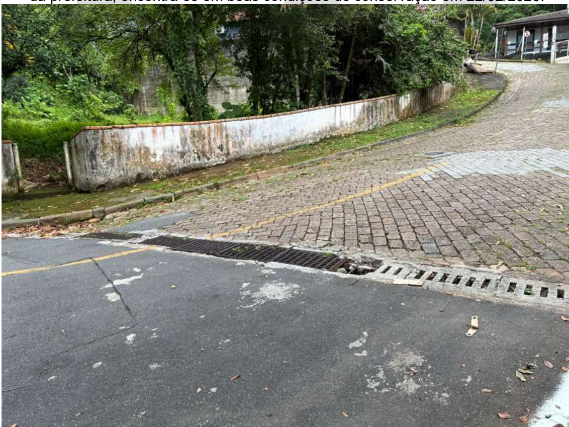
Imagem 6: Rua Otto Eduardo Lepper na transição do pavimento asfáltico e paralelepípedo, drenagem existente danificada em 22/02/2026
