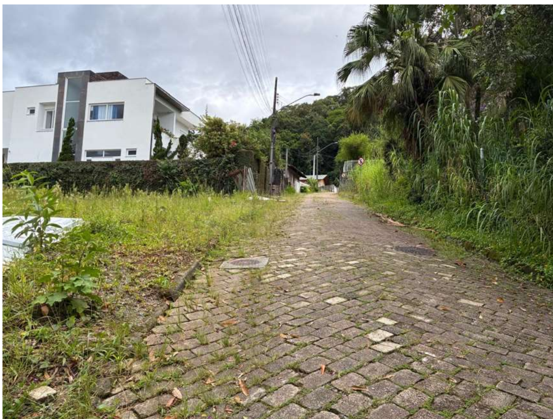
Imagem 13: Rua Otto Eduardo Lepper, a via encontra-se em boas condições de conservação em frente ao empreendimento, calçadas inexistentes e/ou danificadas em 22/02/2026.
