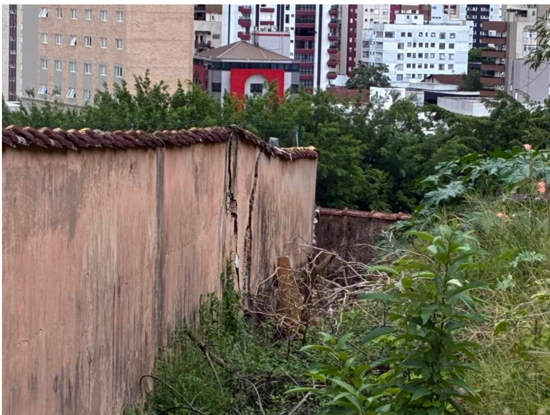
Imagem 21: Muro divisa lado esquerdo danificado com rachaduras expressivas na parte dos fundos do imóvel em 22/02/2026.
