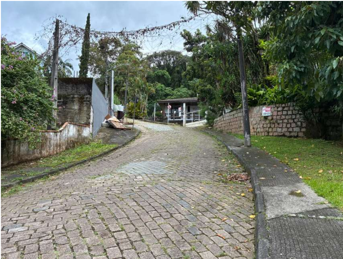
Imagem 7: Rua Otto Eduardo Lepper, a via encontra-se em boas condições de conservação em 22/02/2026.
