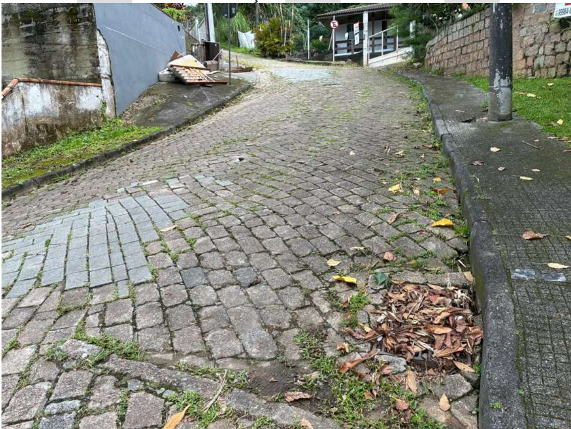
Imagem 8: Rua Otto Eduardo Lepper, bocas de lobo obstruídas em 22/02/2026.
