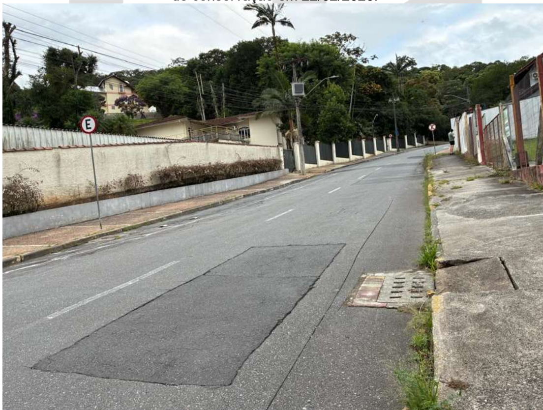
Imagem 2: Início da Rua Otto Eduardo Lepper, a via encontra-se em boas condições de conservação, tampa da boca de lobo danificada em 22/02/2026.
