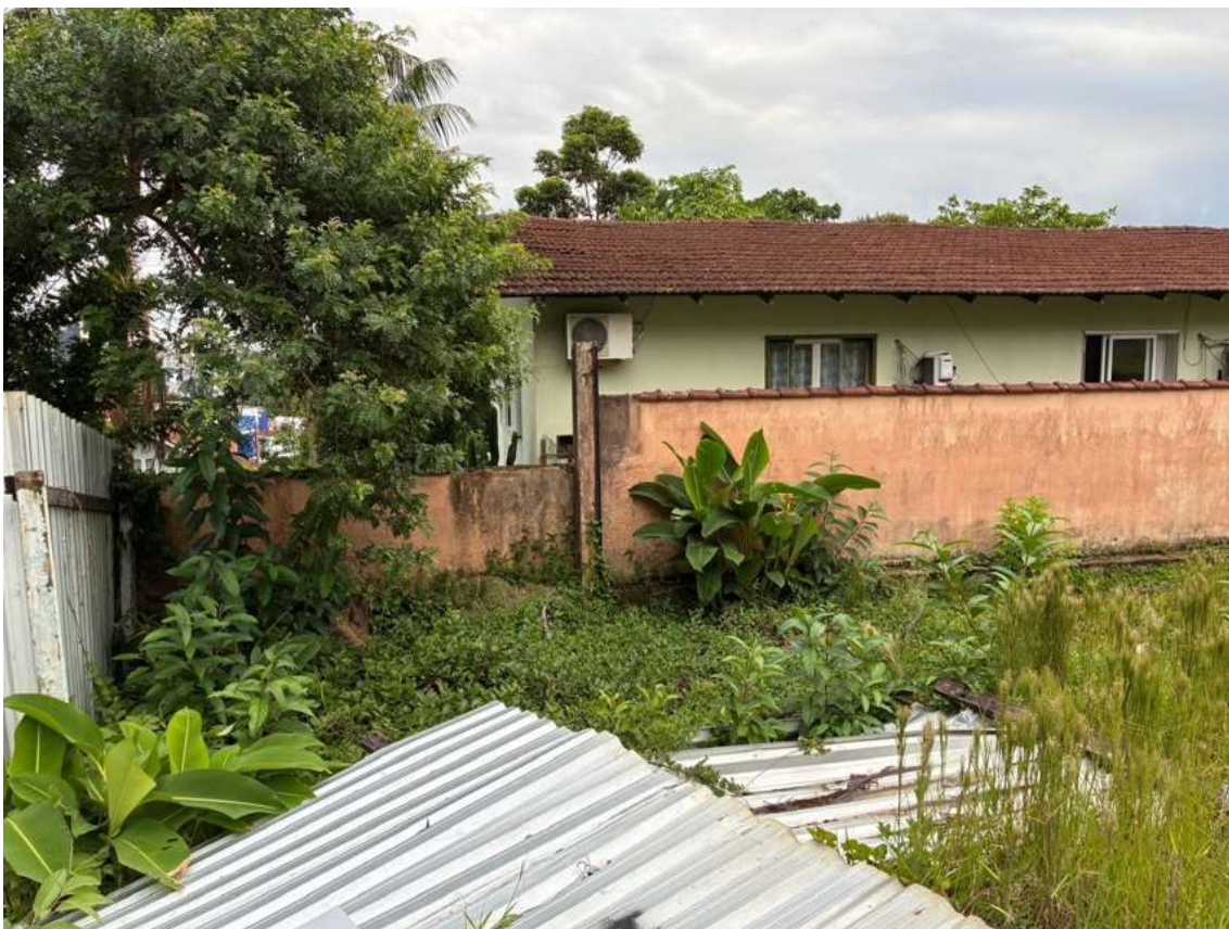
Imagem 23: Muro divisa lado esquerdo em boas condições, com pequenas infiltrações em 22/02/2026.
