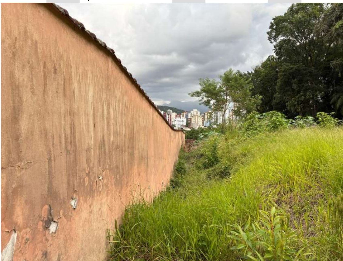
Imagem 22: Muro divisa lado esquerdo em boas condições, com pequenas infiltrações em 22/02/2026.
