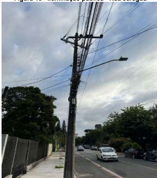
Figura 10 - Iluminação pública - Rua Jaraguá
