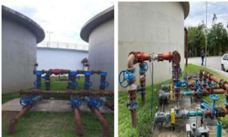
Figura 29 - Elevatória de Deságue de Lodo.
