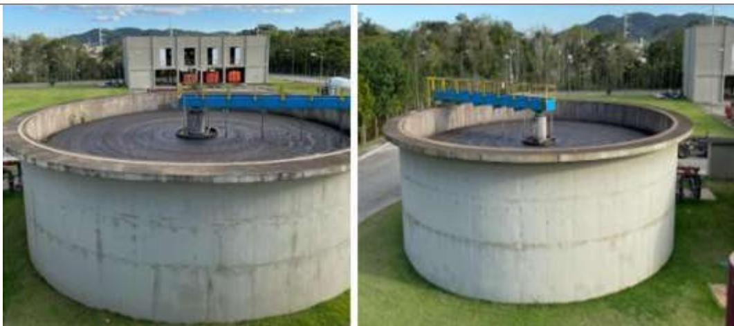
Figura 26 – Adensadores por gravidade da ETE Jarivatuba.
