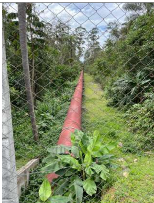
Figura 22 – Emissário final da ETE Jarivatuba
