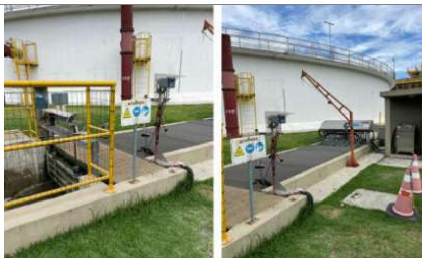
Figura 20 – Canal de desinfecção UV.
