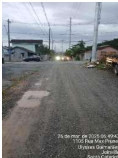
Figura 65 – Rua Eurides Francisco Tomasoni (Sentido AB), sem sinalização e pavimento em terra.
