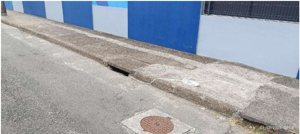
Figura 27: Captação de Drenagem Pluvial, Rua Saudades.
