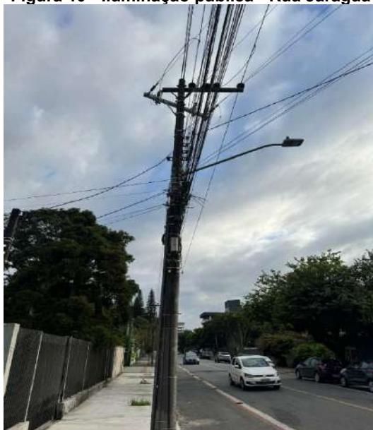
Figura 10 - Iluminação pública - Rua Jaraguá
