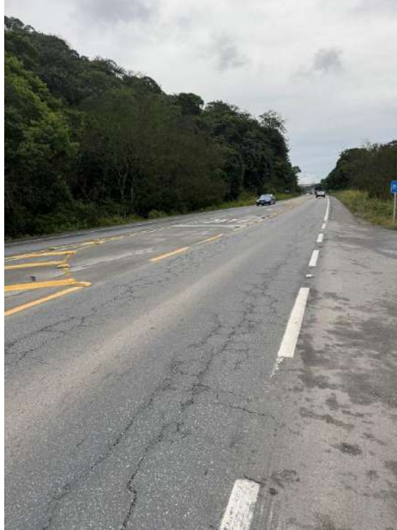
Figura 8 - Ausência de drenagem visível na Rua Rodolfo Jahn
