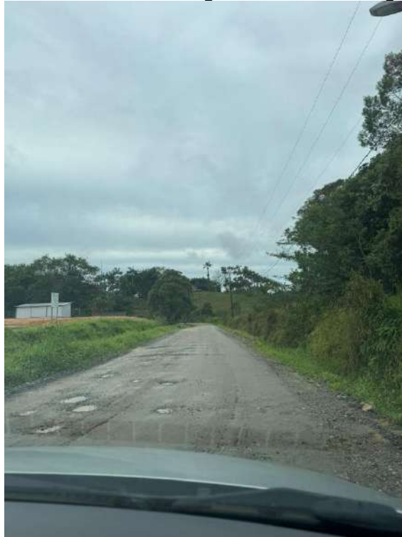
Figura 9 - Ausência de drenagem na Rua dos Portugueses
