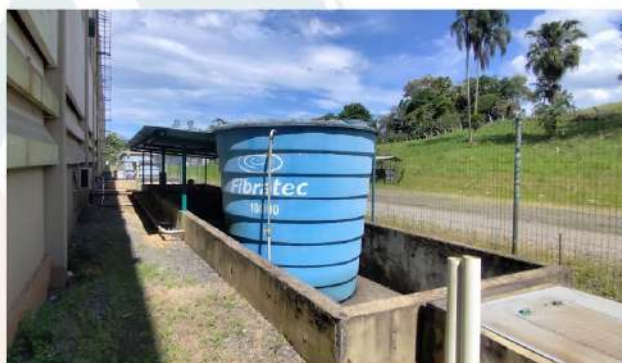
Cisterna de armazenamento de água subterrânea.
