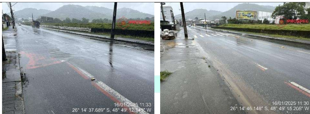
Figura 34: Condições da ciclofaixa no entorno em frente ao imóvel.
