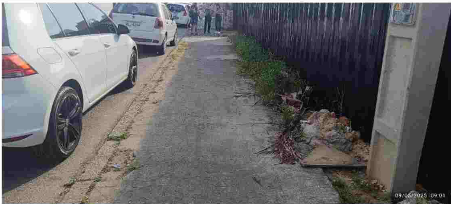
Figura 66: Aspecto da calçada, em frente ao imóvel.
