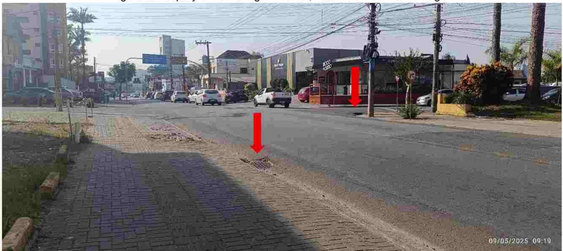
Figura 30: Captação de Drenagem Pluvial, Rua Ministro Calógeras.
