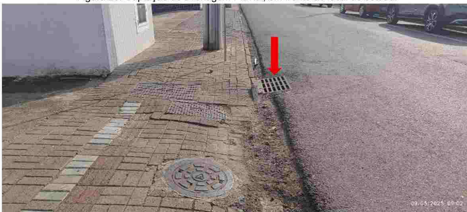
Figura 26: Captção de Drenagem Pluvial, Travessa São José.
