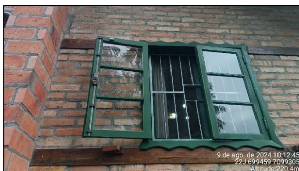
Detalhe originais das janelas - Casa Valdir Bartz Localização: 22J 699459 7099305
