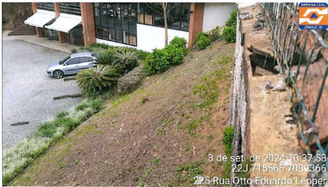
Muro de gabião apenas no começo da base do talude. No restante não há contenção.
