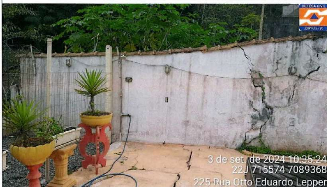
Fraturas com deslocamento
