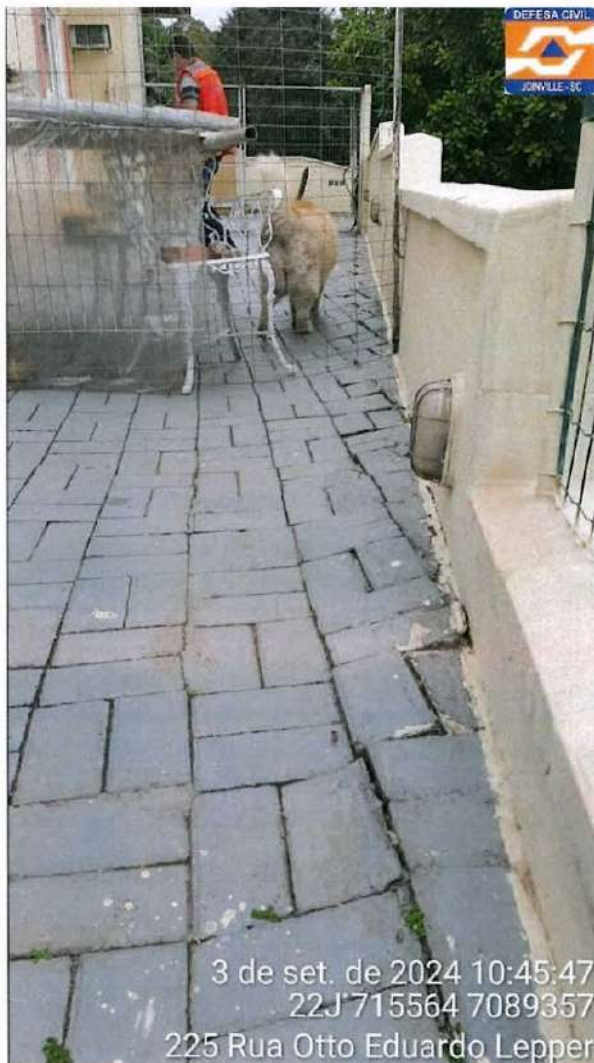
Chão abaulado indicando movimentação
