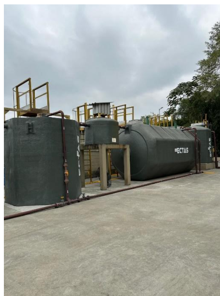
Estação de Tratamento de Efluente Sanitário
