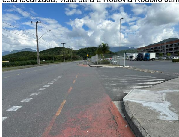
Faixa de pedestres apagada em frente ao acesso de pedestres e veículos da Krona
