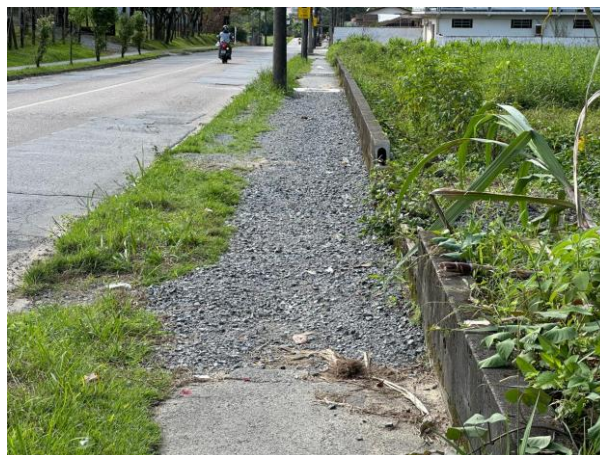
Calçada danificada próxima ao entrocamento com a Rua Otto Albano Ganzemuller
