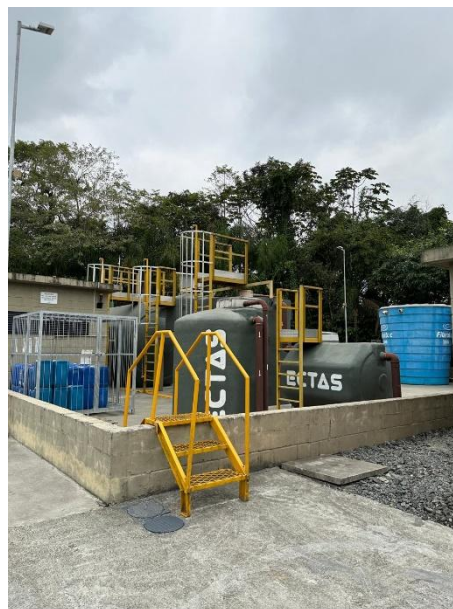
Estação de Tratamento de Efluente Sanitário
