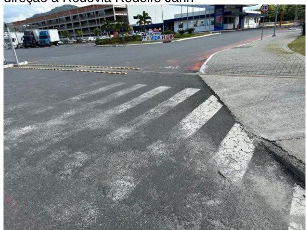
Faixa de pedestres apagada em frente ao acesso de pedestres e veículos da Krona
