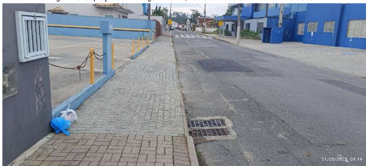
Figura 29: Captação de Drenagem Pluvial, Rua Herval do Oeste, em frente ao local de estudo.
