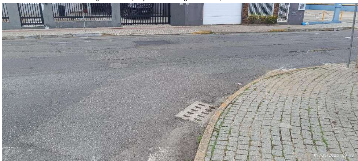
Figura 28: Captação de Drenagem Pluvial, Rua Saudades com Rua Herval do Oeste.
