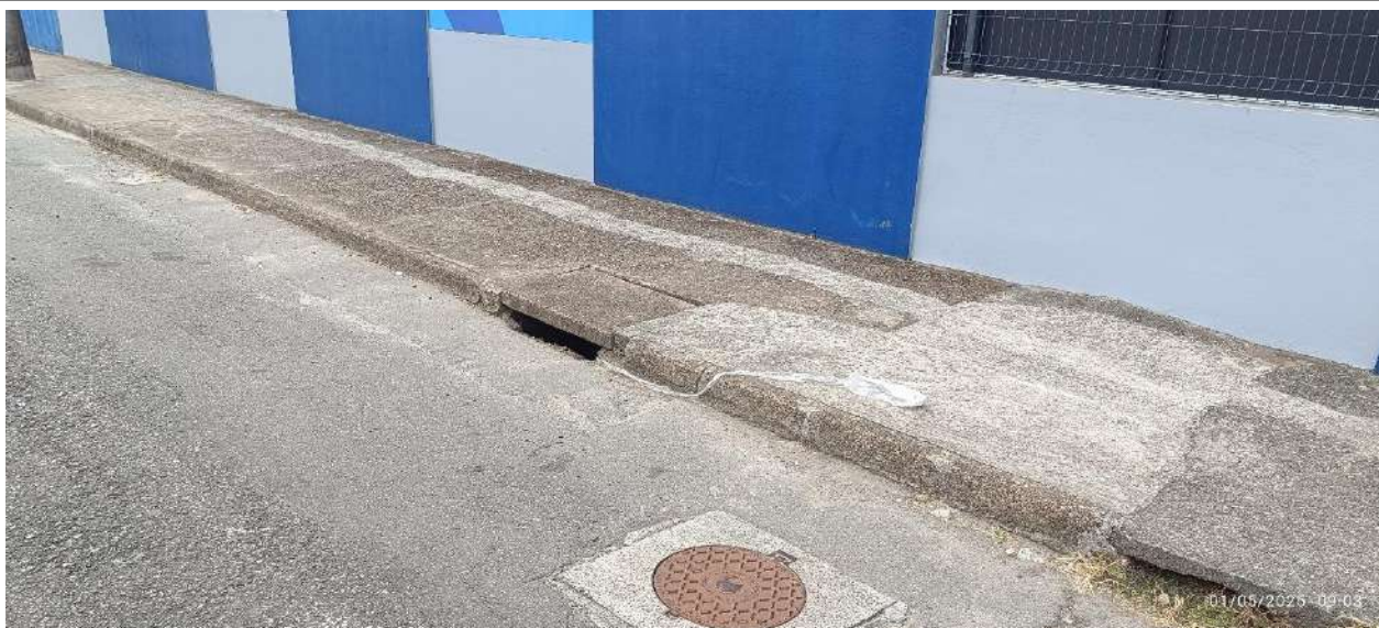
Figura 27: Captação de Drenagem Pluvial, Rua Saudades.
