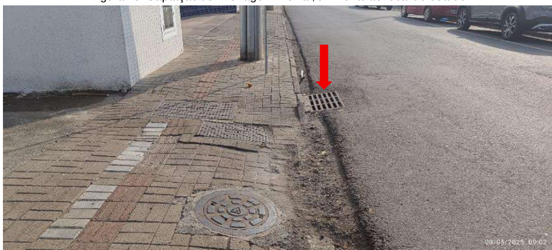
Figura 26: Captção de Drenagem Pluvial, Travessa São José.
