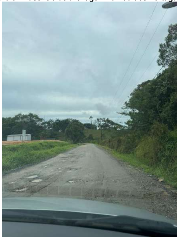
Figura 9 - Ausência de drenagem na Rua dos Portugueses
