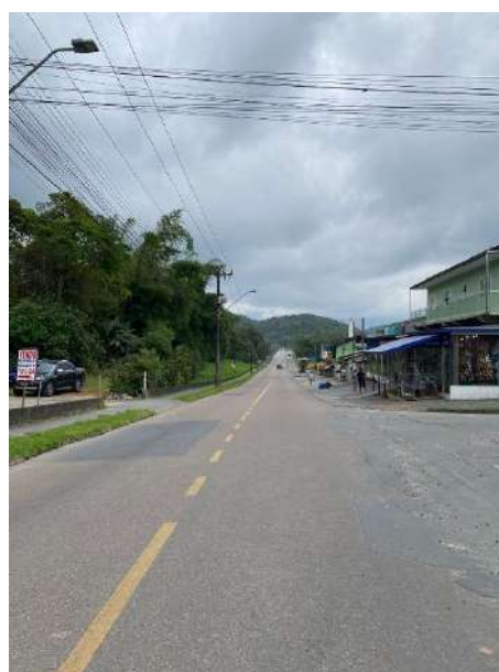
Desnívelamento do asfalto ocasionado por obras de rede de esgoto
