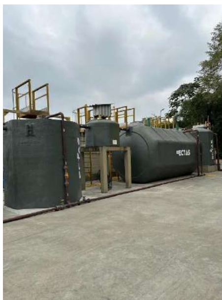
Estação de Tratamento de Efluente Sanitário
