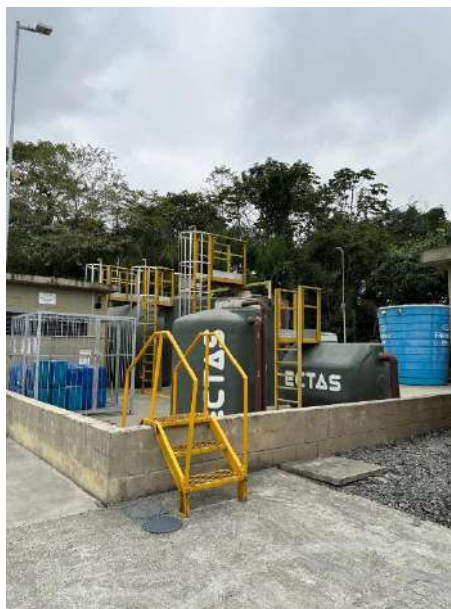
Estação de Tratamento de Efluente Sanitário
