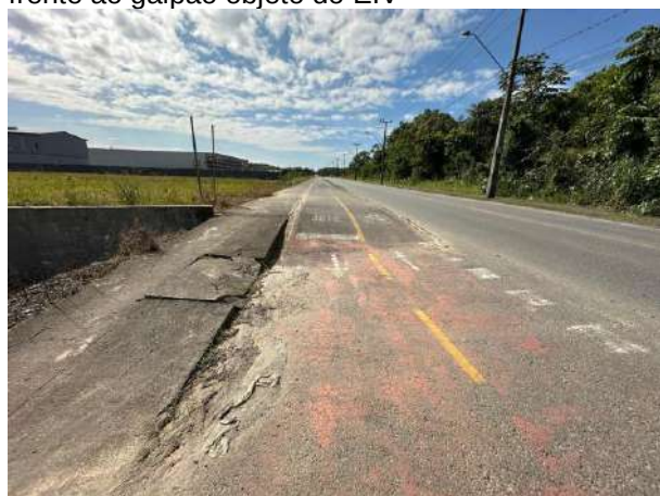
Ciclofaixa em frente a empresa na Rua dos Suíços com pintura apagada, quase esquina com a Rodovia Rodolfo Jahn
