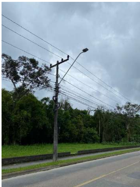
Rede de iluminação pública do lado oposto ao empreendimento
