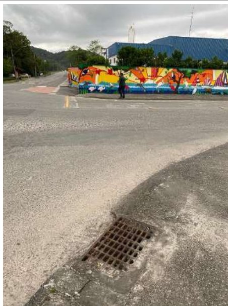
Boca de lobo na extensão de 1 km em frente à Krona
