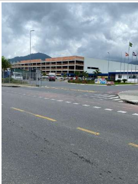
Faixa de pedestres e ciclofaixa com pintura apagada na entrada do empreendimento
