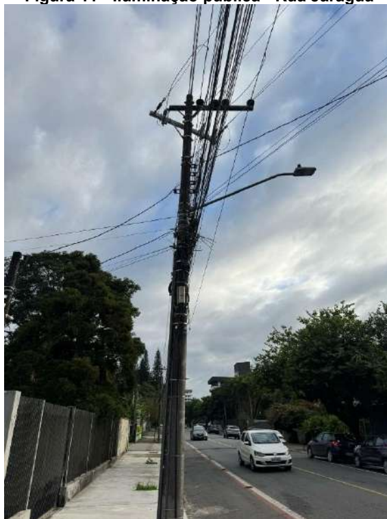
Figura 11 - Iluminação pública - Rua Jaraguá
