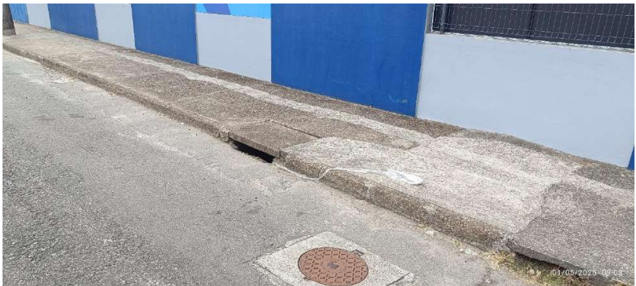
Figura 27: Captação de Drenagem Pluvial, Rua Saudades.
