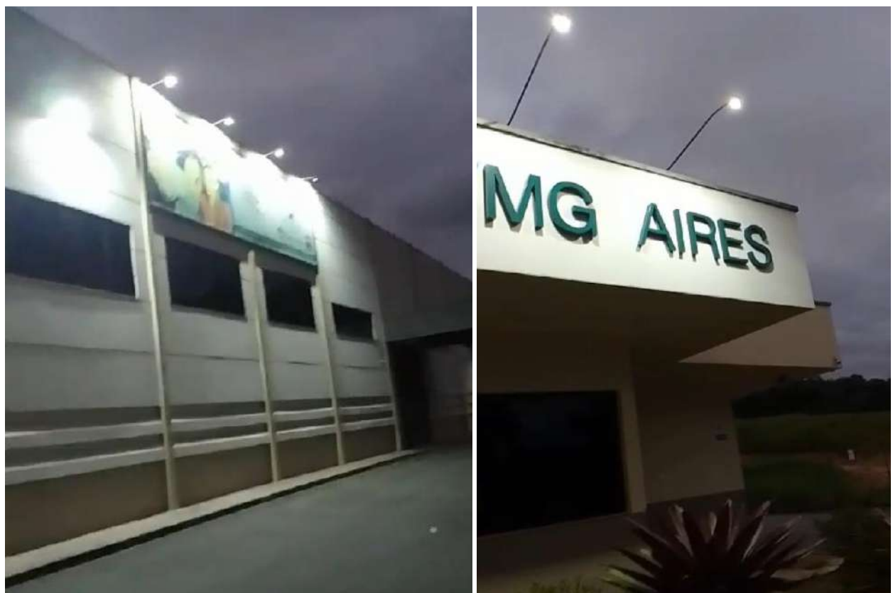
Figura 46: Lateral do galpão (esq.) e guarita (dir.) com refletores acionados no período noturno.
