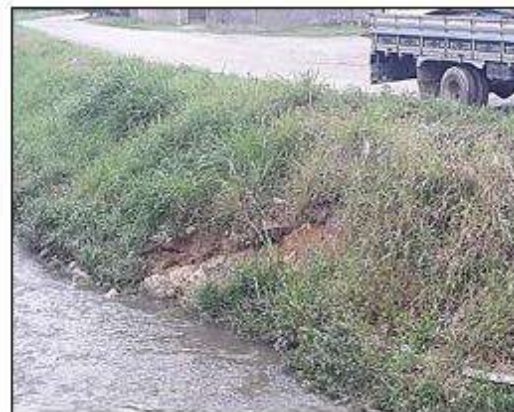
Solapamento de margens (ponto 2)
