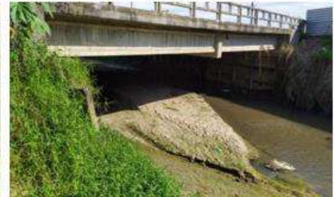
Assoreamento sobre a ponte, na rua dos Aimorés
