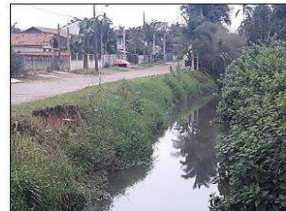
Solapamento de margens (ponto 3)
