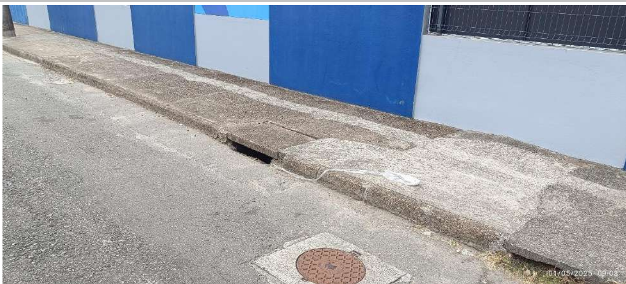
Figura 28: Captação de Drenagem Pluvial, Rua Saudades.
