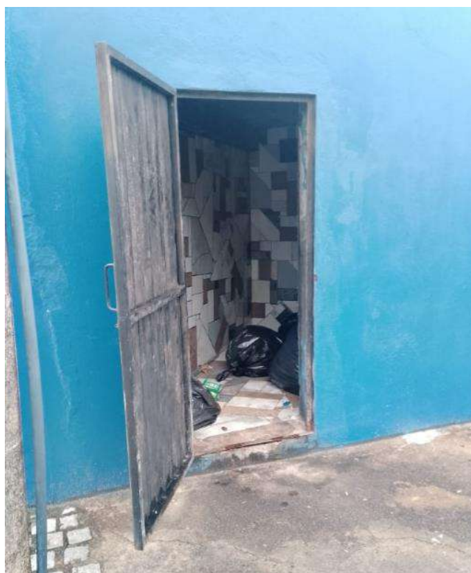
Figura 39: Lixeira para Armazenamento de Resíduo.
