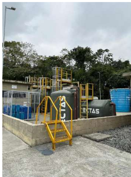
Estação de Tratamento de Efluente Sanitário
