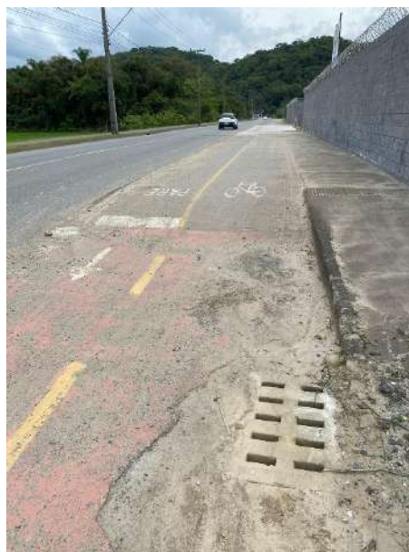
Trecho de ciclofaixa danificada entre o empreendimento e a Rodovia Rodolfo Jahn
