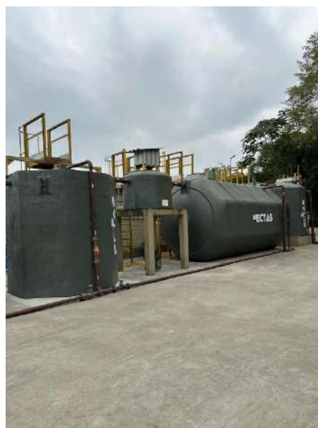
Estação de Tratamento de Efluente Sanitário
