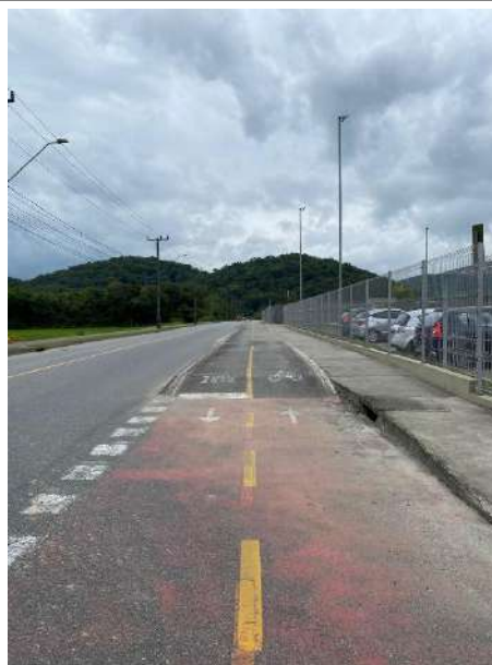
Faixa de pedestres e ciclofaixa com pintura apagada entre a entrada de caminhões e entrada principal do empreendimento
