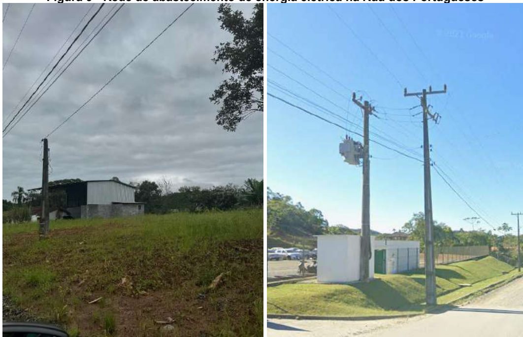
Figura 9 - Rede de abastecimento de energia elétrica na Rua dos Portugueses
