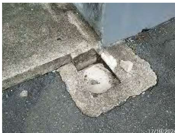
Figura 34 - Caixa de gordura anexa ao Galpão 1.
