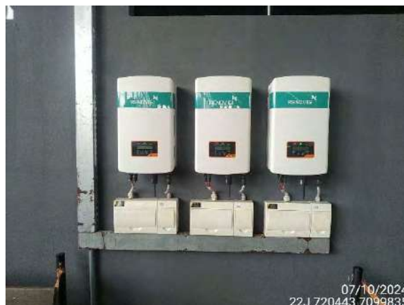
Figura 24 - Inversores solares do empreendimento.
