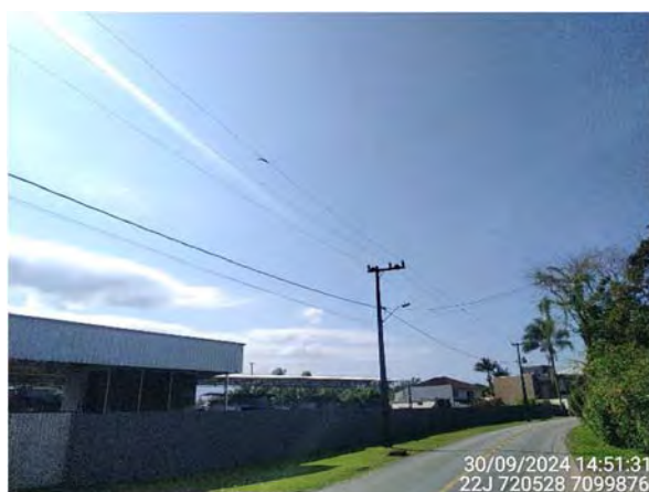
Figura 20 – Poste de iluminação pública em frente ao empreendimento.
