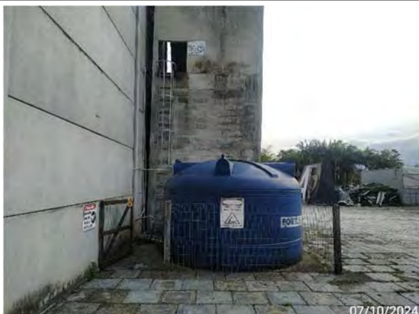
Figura 25 – Reservatório de água da chuva.
