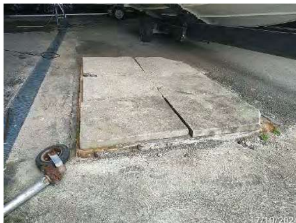
Figura 36 - Caixa de sedimentação de partículas e separador de água e óleo anexa ao Galpão 3.
