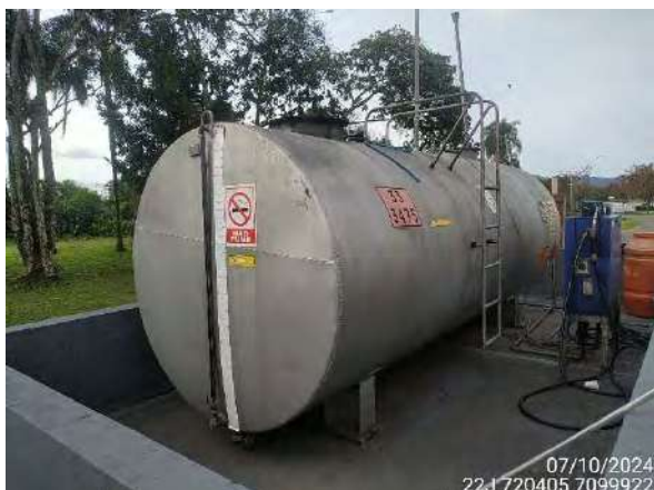
Figura 37 - Tanque de abastecimento de embarcações
