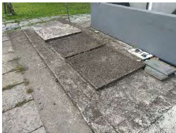
Figura 38 - Caixa de sedimentação de partículas e separador de água e óleo anexa ao tanque de abastecimento de embarcações.
