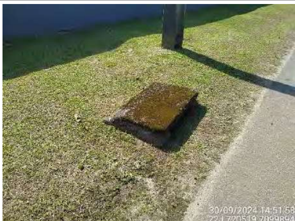
Figura 17 - Caixa de passagem na área externa do empreendimento.
