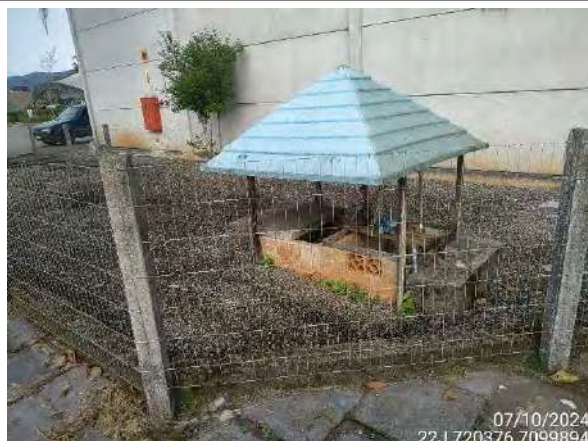
Figura 26 – Sistema de bombeamento.
