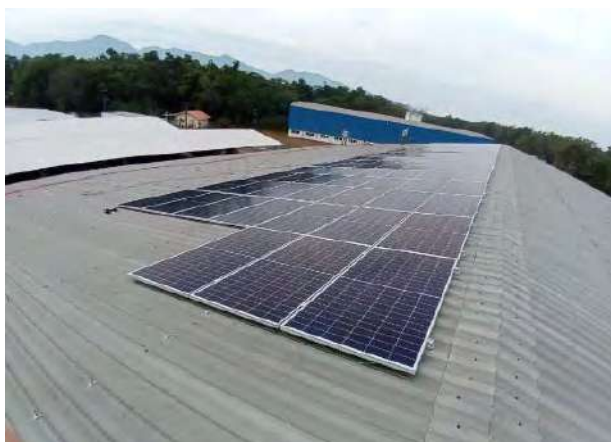
Figura 23 – Painéis solares no empreendimento.
