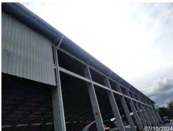
Figura 27 – Sistema de captação da água da chuva.
