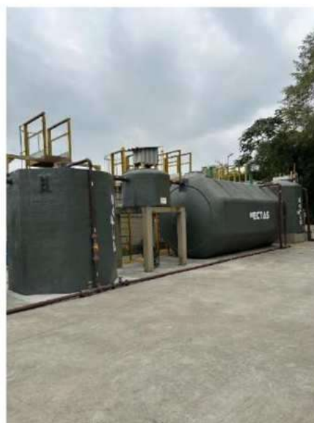
Estação de Tratamento de Efluente Sanitário
