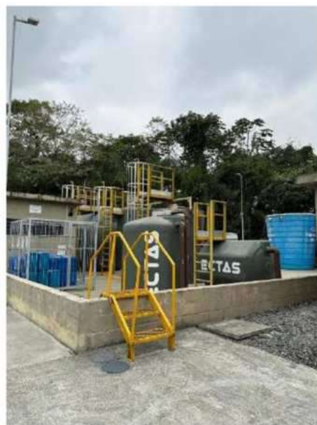
Estação de Tratamento de Efluente Sanitário
