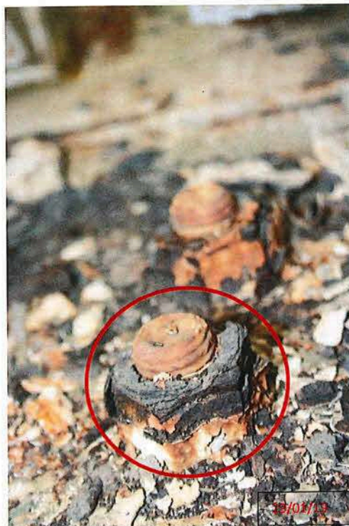
Foto 6- Delaminação das porcas de junção das tesouras
