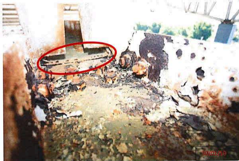
Foto 18- Desalinhamento na junção parafusada (TS9/TS13)
