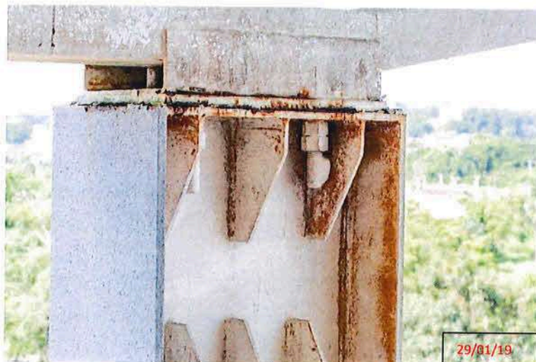
Foto 4-Corrosão nos apoios
