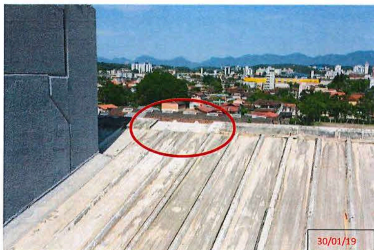
Foto 30 – Falta de cumeeira
