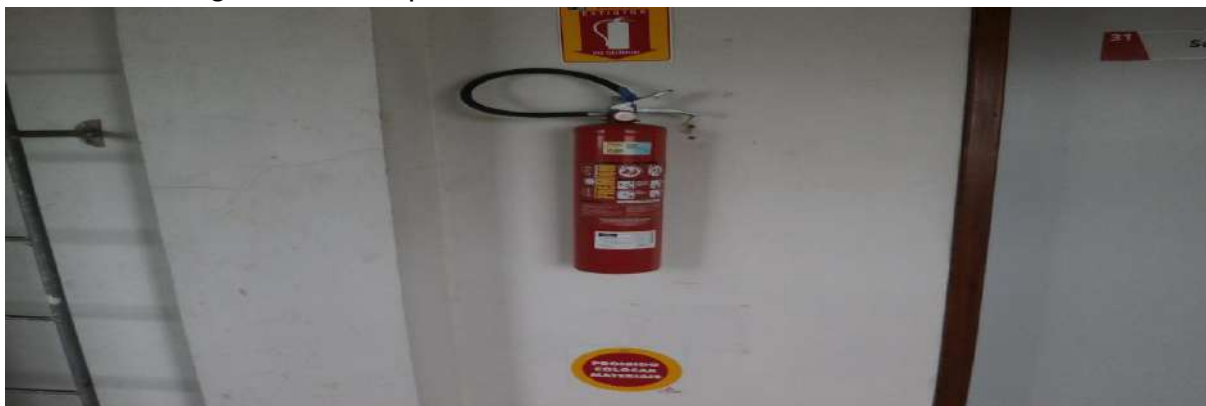
Foto 24 – sistema preventivo contra incêndio no Estádio
