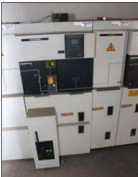
Figura 26: Painéis da subestação de energia do empreendimento.
