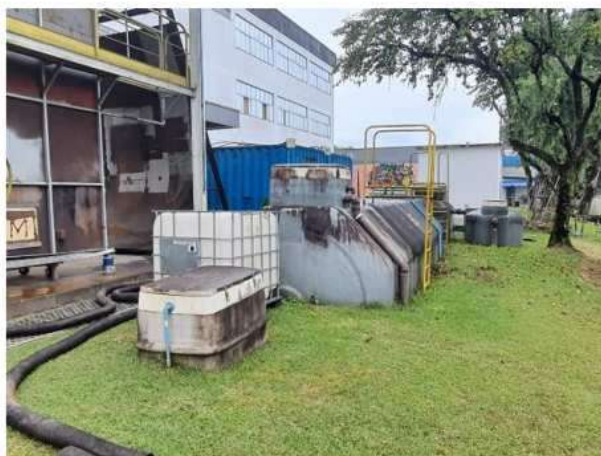
Figura 26 - Sistema de Tratamento de Efluentes - ETE
