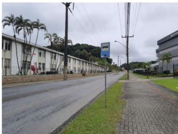
Figura 14 - Situação da pavimentação no sentido oeste - leste
