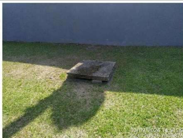
Figura 18 - Caixa de passagem na área externa do empreendimento.
