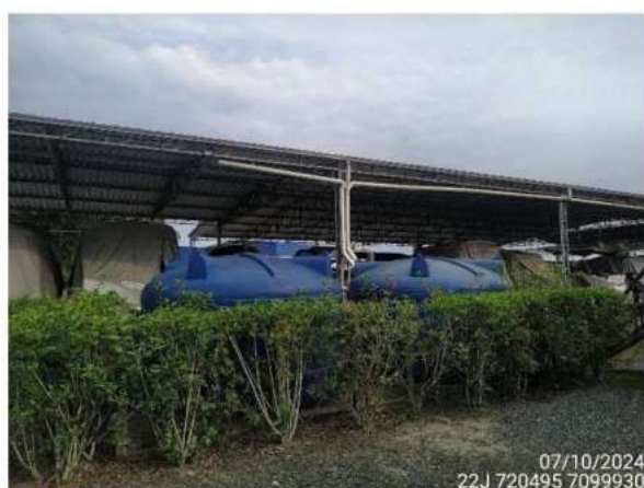
Figura 28 – Sistema de captação e reservação de água da chuva.
