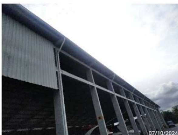
Figura 27 – Sistema de captação da água da chuva.
