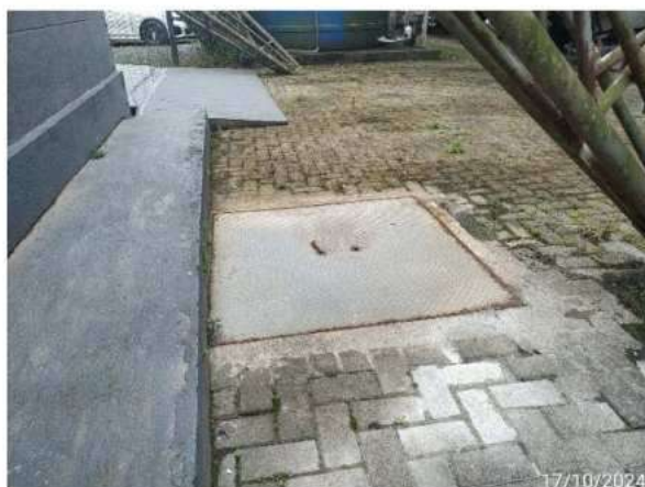
Figura 33 - Caixa de gordura anexa ao restaurante.
