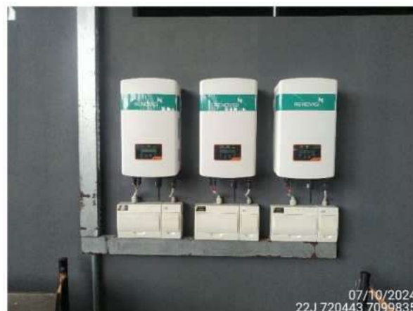
Figura 24 - Inversores solares do empreendimento.
