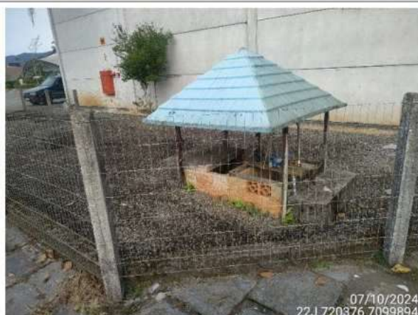
Figura 26 – Sistema de bombeamento.
