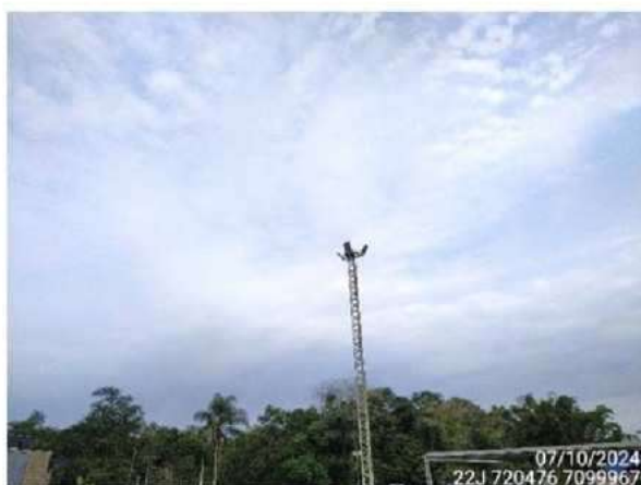
Figura 21 – Poste de iluminação localizada no estacionamento do empreendimento.
