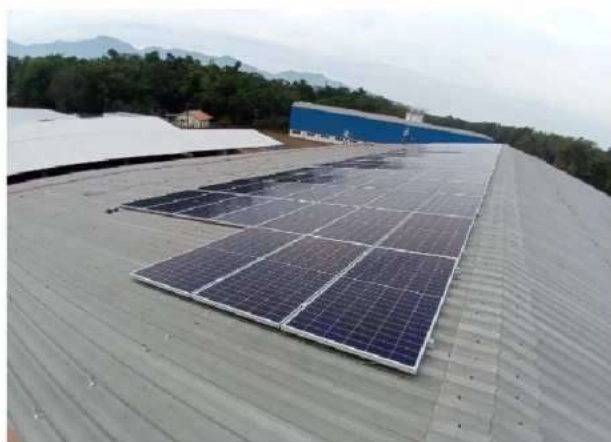
Figura 23 – Painéis solares no empreendimento.
