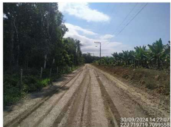
Figura 10 – Trecho da Rua Alvino Souza do Nascimento não pavimentado e situado na AID.
