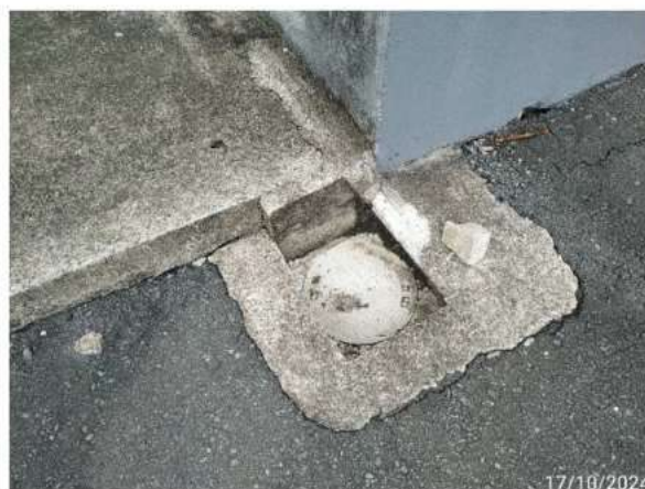
Figura 34 - Caixa de gordura anexa ao Galpão 1.
