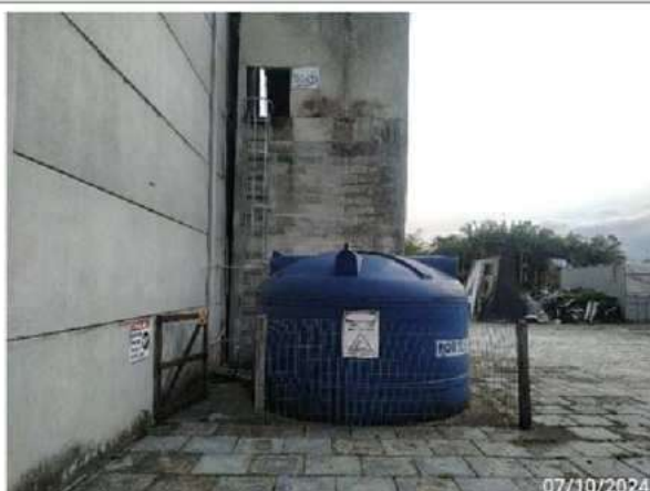
Figura 25 – Reservatório de água da chuva.
