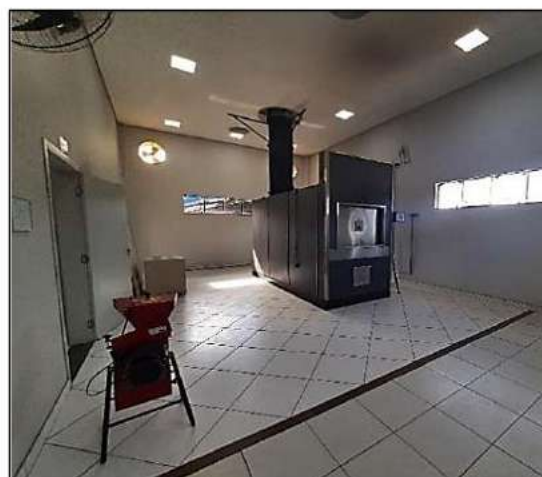
Figura 6. Forno do Crematório Fonte: Doré Engenharia, 2022.
