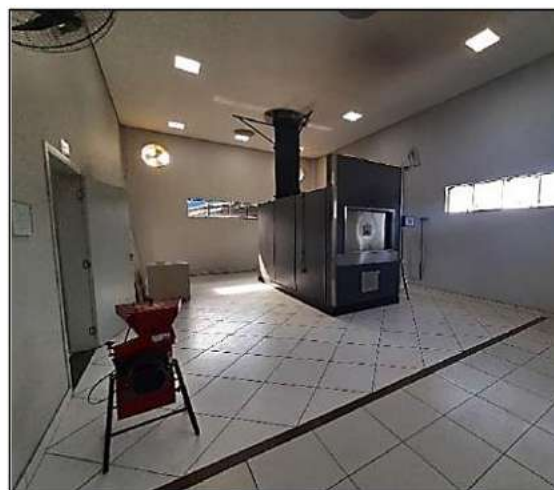
Figura 4. Forno do Crematório Fonte: Doré Engenharia, 2022.
