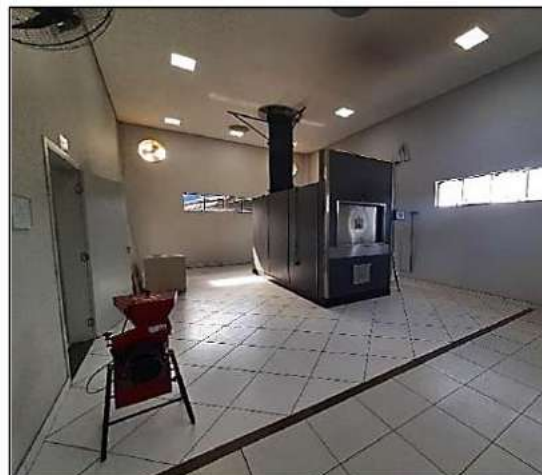
Figura 6. Forno do Crematório Fonte: Doré Engenharia, 2022.
