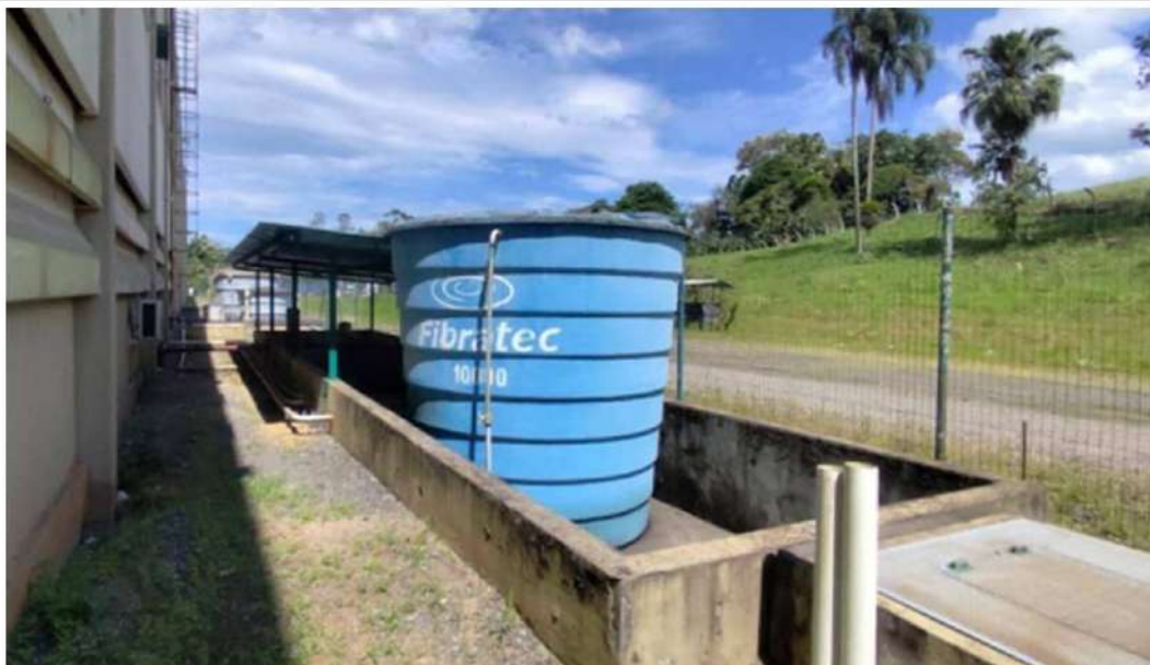
Figura 37: Cisterna de armazenamento de água subterrânea.
