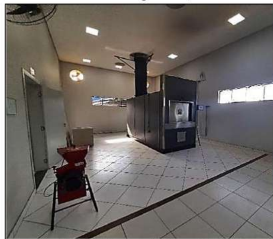
Figura 6. Forno do Crematório Fonte: Doré Engenharia, 2022.
