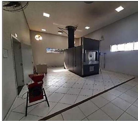
Figura 4. Forno do Crematório Fonte: Doré Engenharia, 2022.
