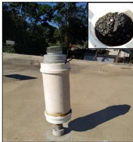
Figura 22. Parte superior do sistema de Filtração de e gases (Cemitério Vertical de Maringá) Fonte: Doré Engenharia, 2020
