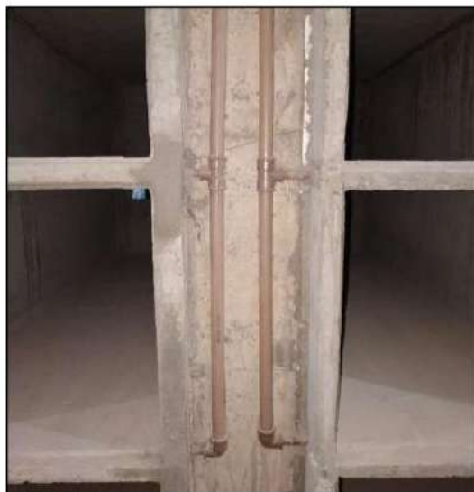
Figura 21. Sistema de filtração de gases (Cemitério Vertical de Maringá) Fonte: Doré Engenharia, 2020
