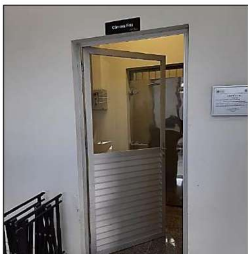
Figura 7. Câmara Fria Fonte: Doré Engenharia, 2022.
