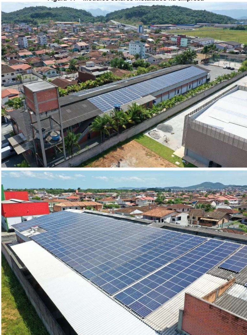
Figura 41 – Módulos solares instalados na empresa
