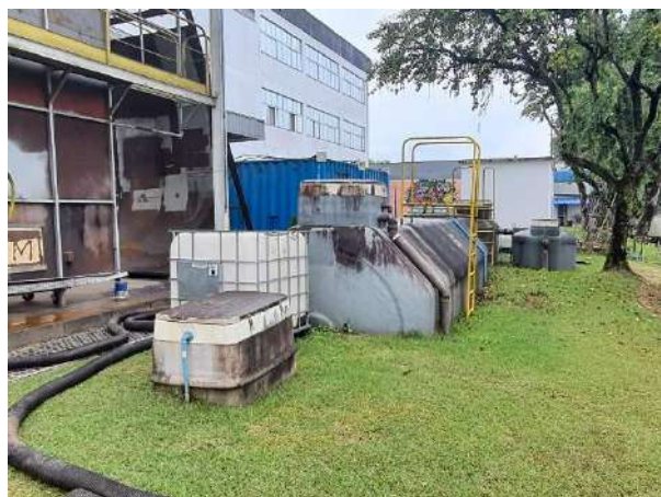
Figura 26 - Sistema de Tratamento de Efluentes - ETE
