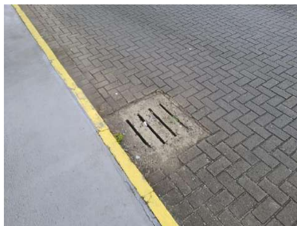
Figura 20 - Sistema de coleta de água pluvial no pátio do empreendimento
