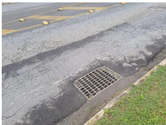
Figura 17 - Boca de lobo em frente ao empreendimento
