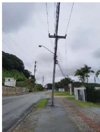
Figura 22 - Iluminação pública na rua em frente ao empreendimento
