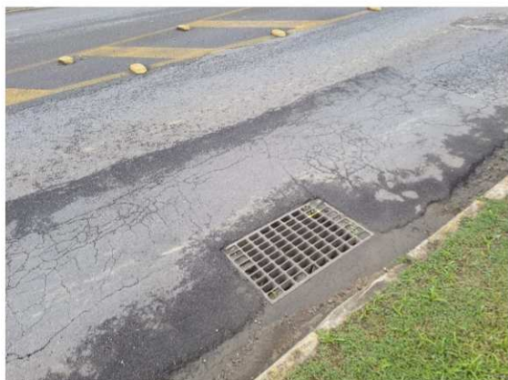
Figura 17 - Boca de lobo em frente ao empreendimento
