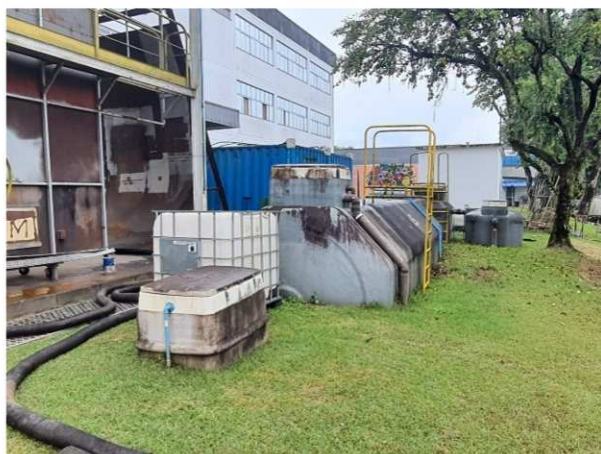
Figura 26 - Sistema de Tratamento de Efluentes - ETE
