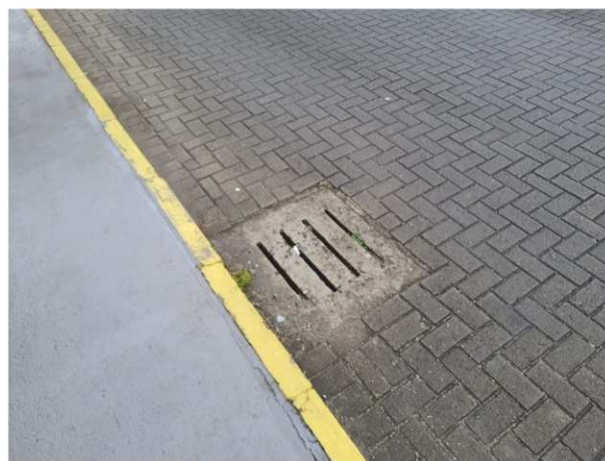
Figura 20 - Sistema de coleta de água pluvial no pátio do empreendimento
