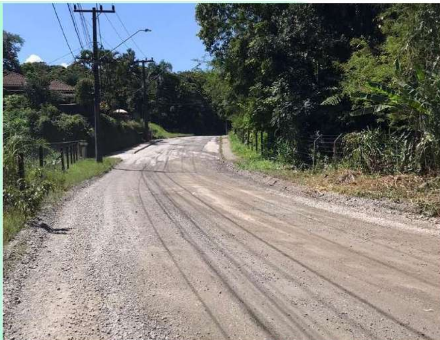
Figura 59 – Rua Anaburgo, trecho não pavimentado.
