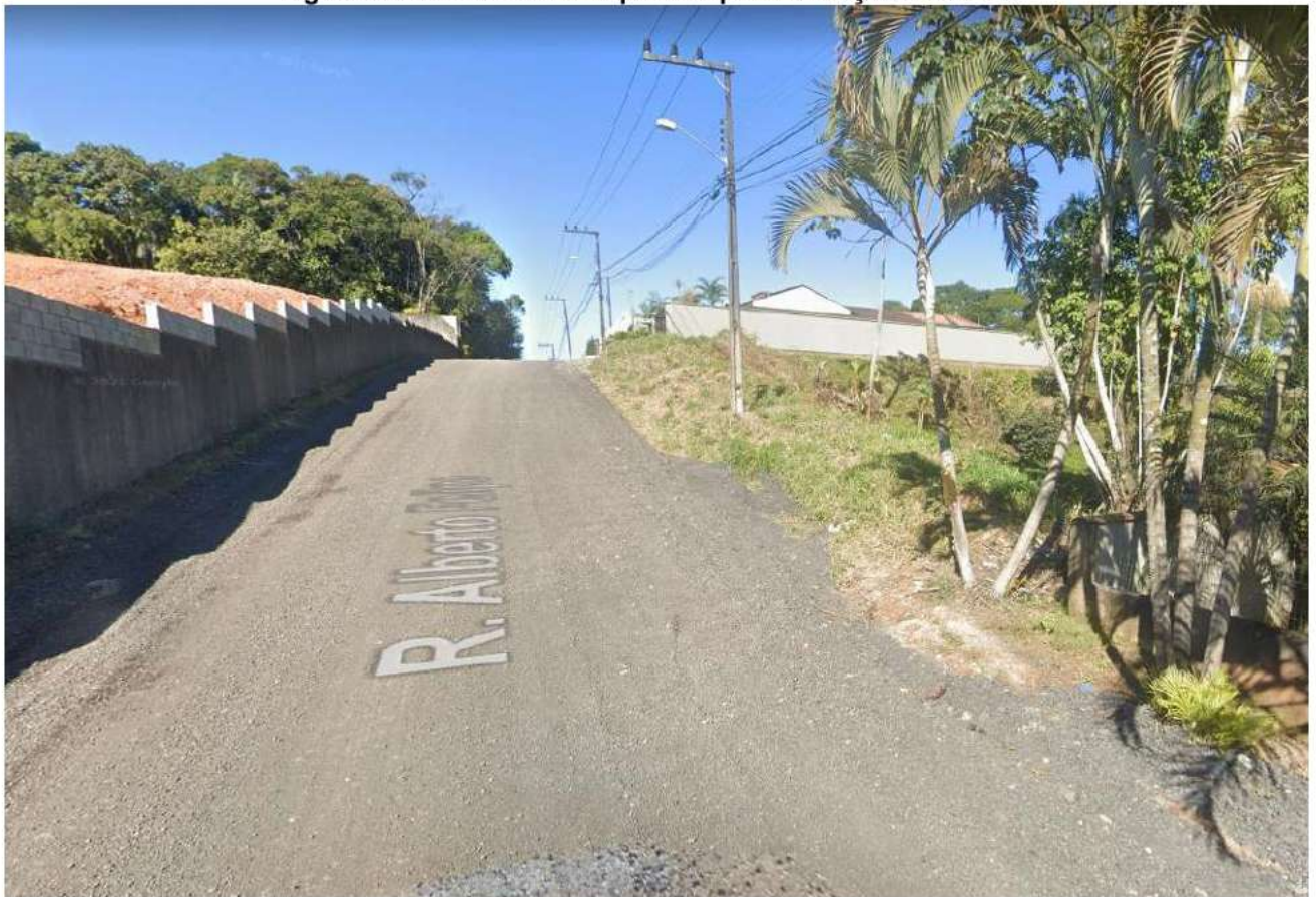
Figura 41- Rua Alberto Felipe sem pavimentação asfáltica.
